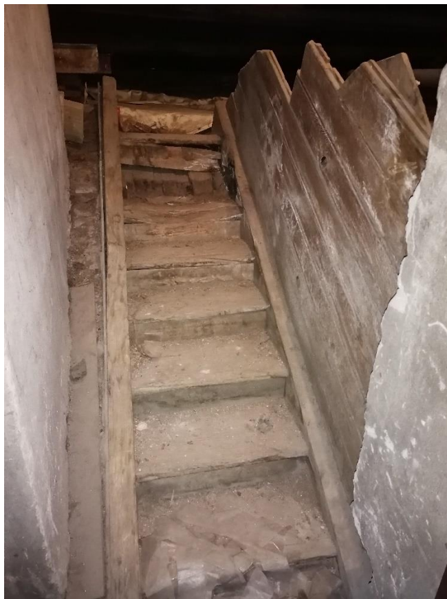
Илл.32. Деревянная лестница на чердак в части здания со стороны Полюстровского проспекта. 31.03.2022г.
