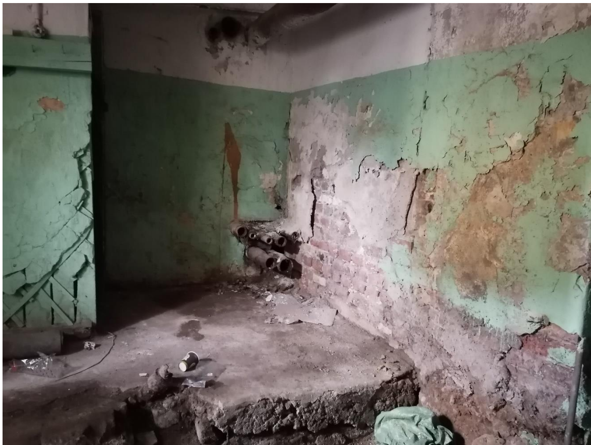
Илл.64. Подвал. Помещение №1 в части здания со стороны Поллюстровского проспекта. Теплоцентр. 31.03.2022г.
