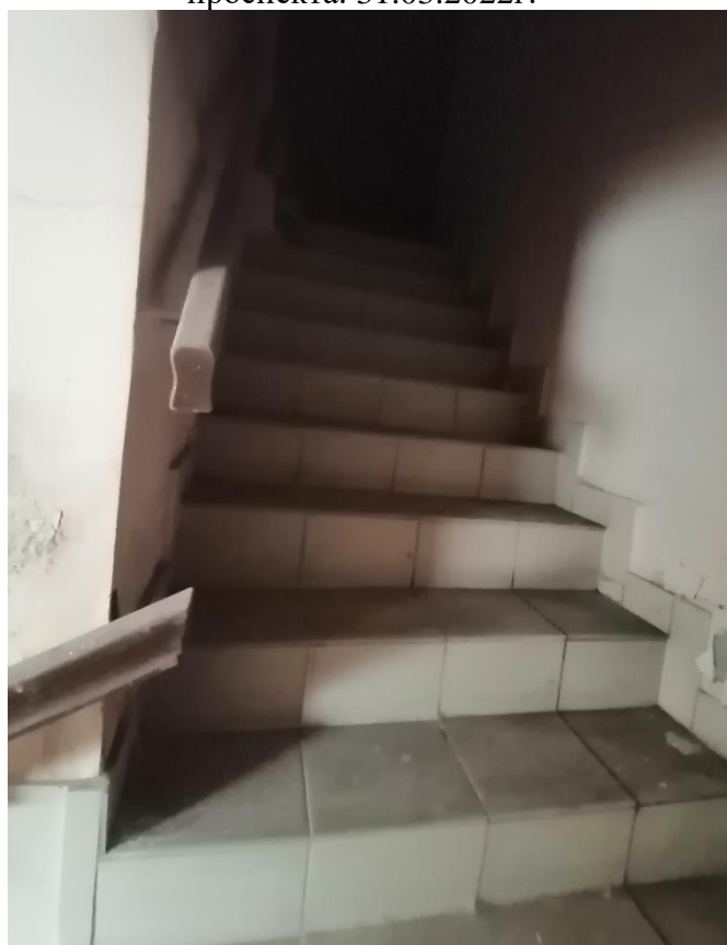
Илл.44. Подвал. Лестница из помещения №4 в части здания со стороны Полюстровского проспекта. 31.03.2022г.
