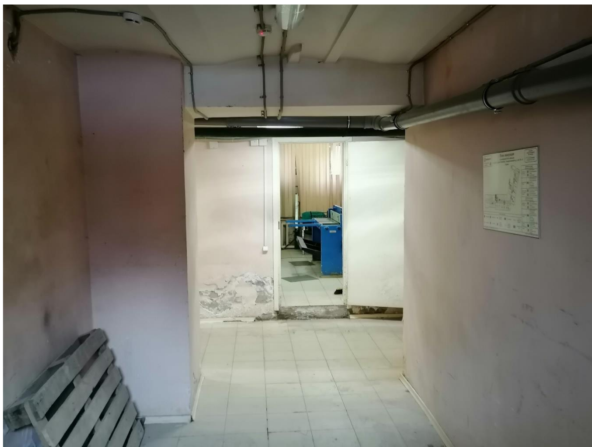
Илл.40. Подвал. Вход в подвал в части здания со стороны Полюстровского проспекта. 31.03.2022г.
