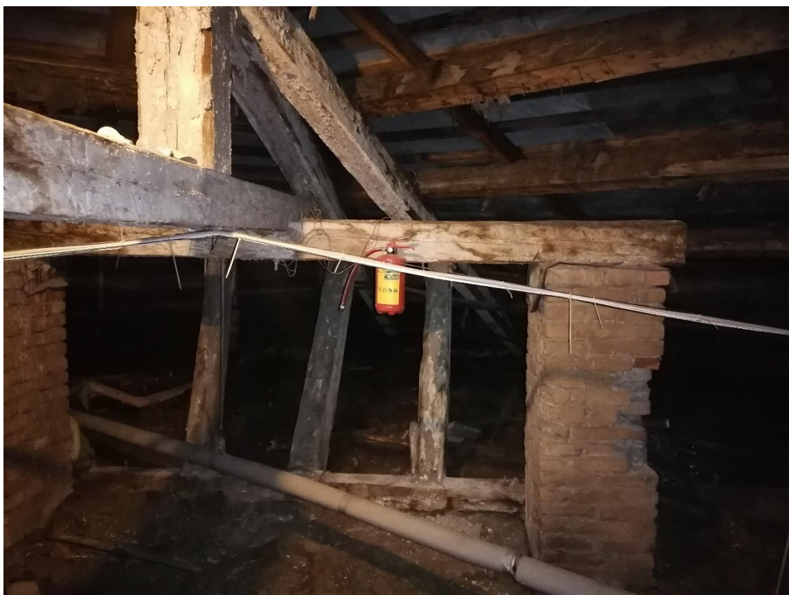
Илл.34. Состояние деревянных чердачных конструкций. 31.03.2022г.
