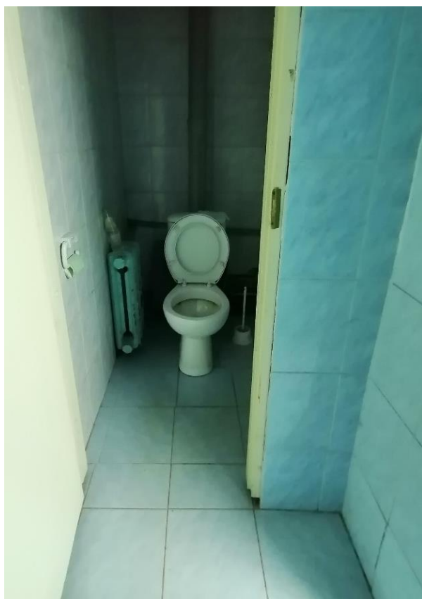
лл.41. Подвал. Санузел. Помещение №39 рядом с входным коридором. 31.03.2022г.
