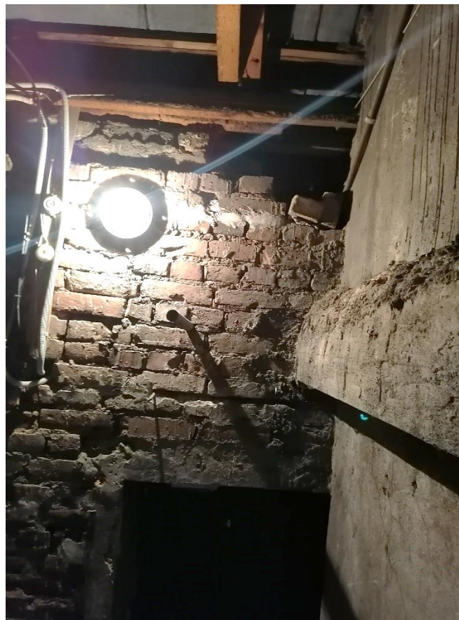
Илл.32-1. Стена над деревянной лестницей на чердак в части здания со стороны Полюстровского проспекта. 31.03.2022г.
