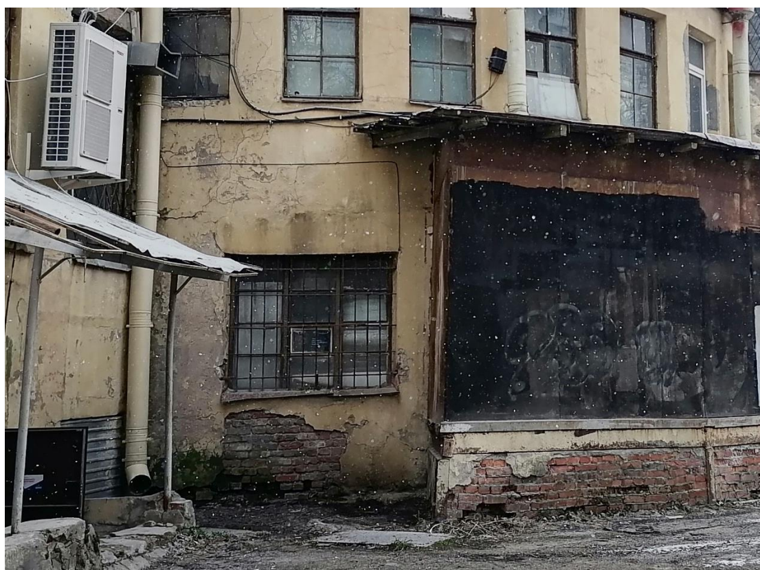
Илл.12. Фрагмент основания центральной полуротонды дворового фасада. 31.03.2022г.
