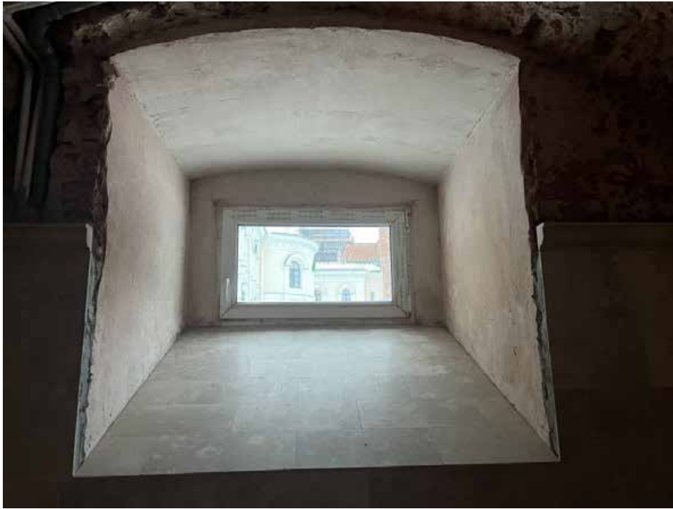
19. Объект культурного наследия федерального значения «Собор Воскресенский», входящий в состав объекта культурного наследия федерального значения «Монастырь Воскресенский Новодевичий», по адресу: г. Санкт-Петербург, Московский проспект, д. 100, лит. А. Подвальный (цокольный) этаж. Нижний храм. Фрагмент интерьера. Оконный проем (заполнение - позднее, не историческое).
