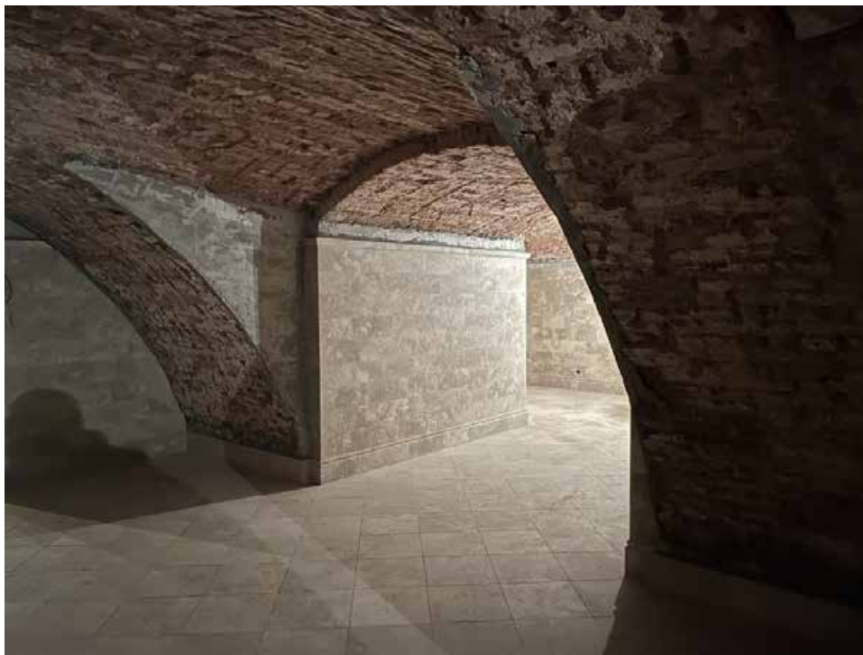
16. Объект культурного наследия федерального значения «Собор Воскресенский», входящий в состав объекта культурного наследия федерального значения «Монастырь Воскресенский Новодевичий», по адресу: г. Санкт-Петербург, Московский проспект, д. 100, лит. А. Подвальный (цокольный) этаж. Нижний храм. Фрагмент интерьера.
