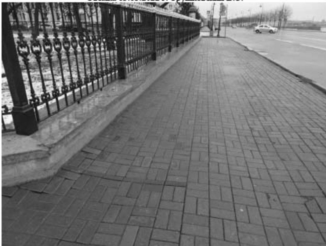
Фото 28. Трогуар вдоль объекта культурного наследия федерального значения «Домик Петра I» (Петровская наб., 6). Вид на восток. Съемка 03.03.2022 г. Трушковский В.Э.
