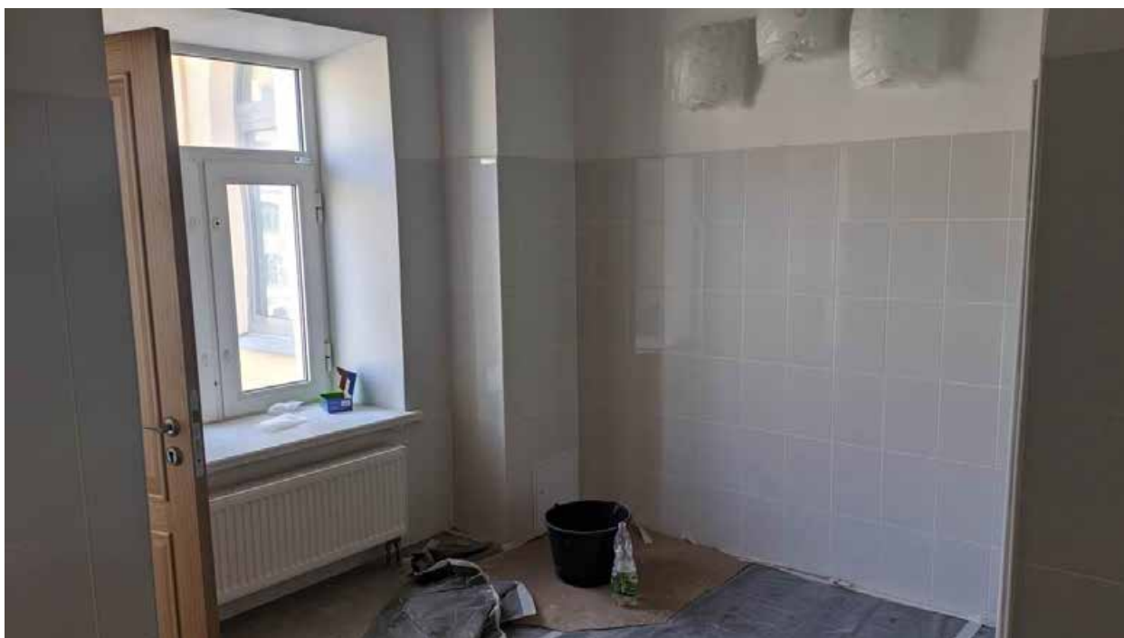
162. Вид в интерьере санузла коридора зоны «Консерватория» в уровне 3-го этажа западного корпуса.
