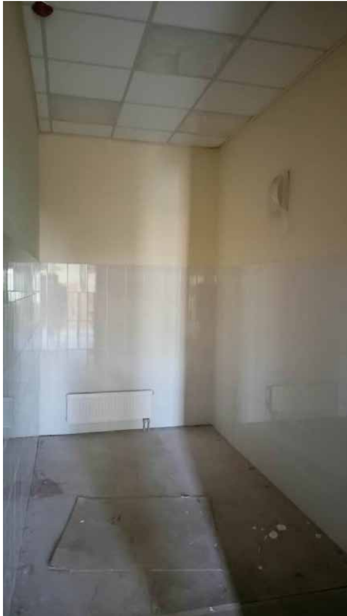
192. Вид в интерьере санузла зоны «Консерватория» в уровне 4-го этажа западного корпуса.
