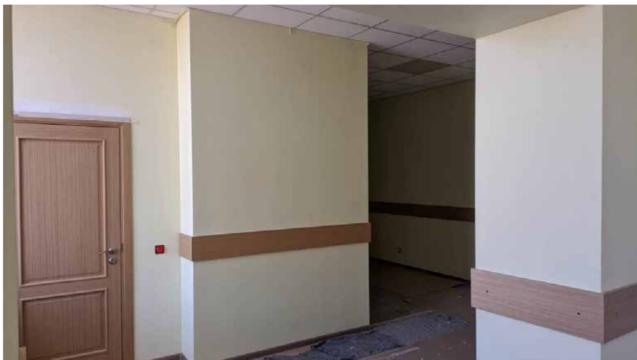
227. Вид в интерьере коридора зоны «Консерватория» в уровне 4-го этажа южного корпуса.
