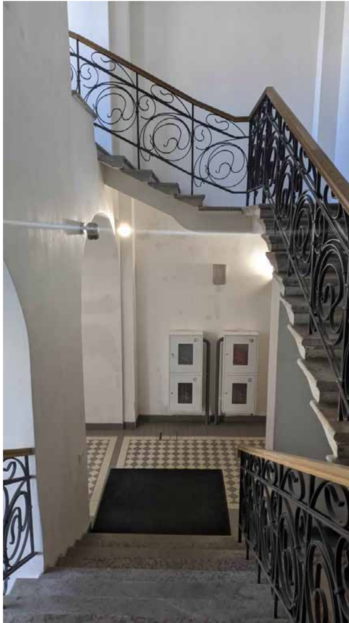
35. Вид с промежуточной площадки лестничной клетки зоны «СЗД» в уровне 1-го этажа южного корпуса.
