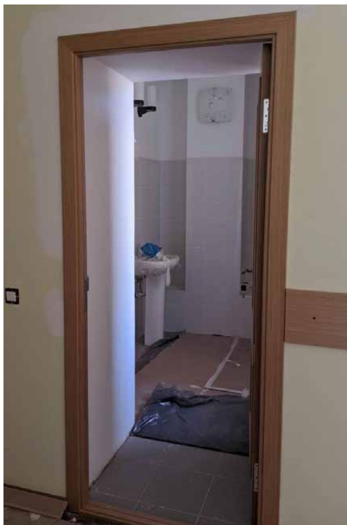
221. Вид в интерьере санузла зоны «Консерватория» в уровне 4-го этажа западного корпуса.
