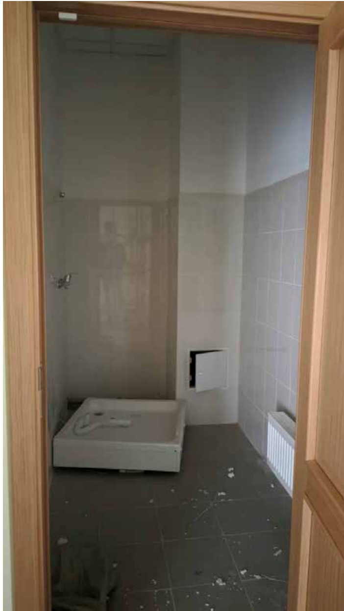
231. Вид в интерьере душевой зоны «Консерватория» в уровне 4-го этажа южного корпуса.
