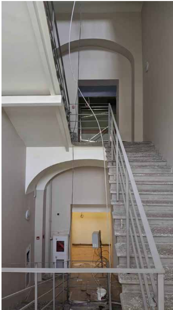
141. Виды в интерьере лестницы зоны «Консерватория» в уровне 1-2-го этажей западного корпуса.
