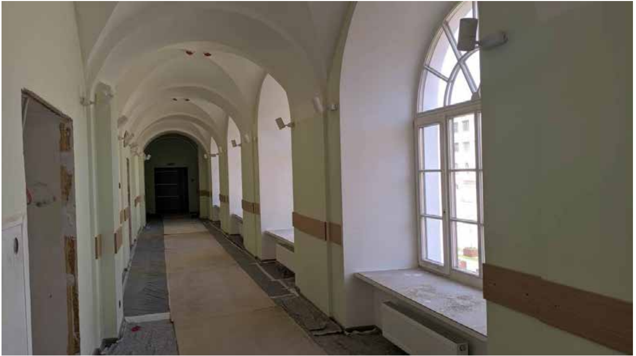
171. Вид в интерьере коридора зоны «Консерватория» в уровне 3-го этажа западного корпуса.
