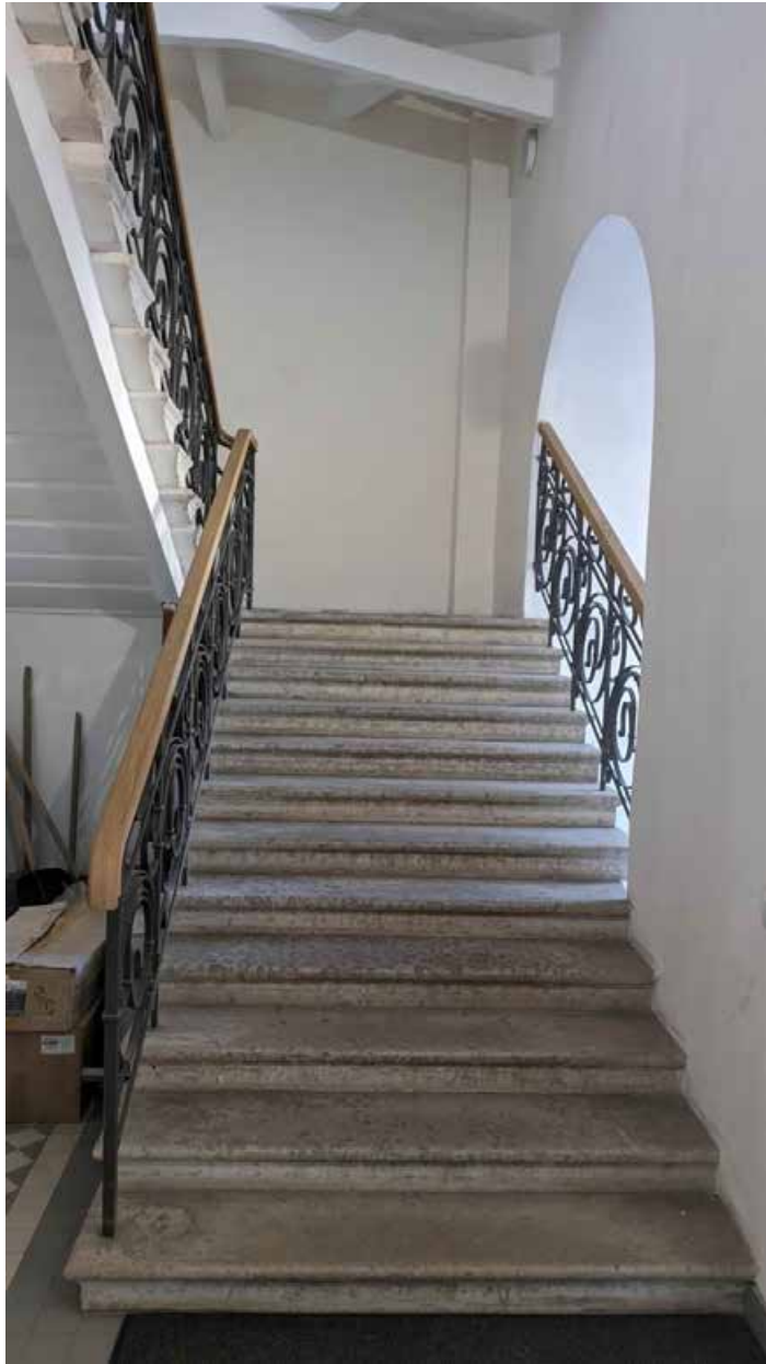
28. Вид на лестничную клетку зоны «СЗД» в уровне 1-го этажа южного корпуса.
