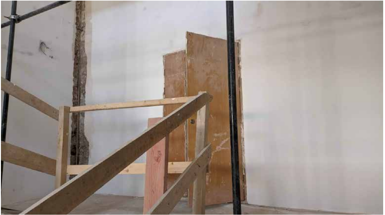
183. Вид на лестничную клетку зоны «Консерватория» в уровне 4-го этажа западного корпуса.
