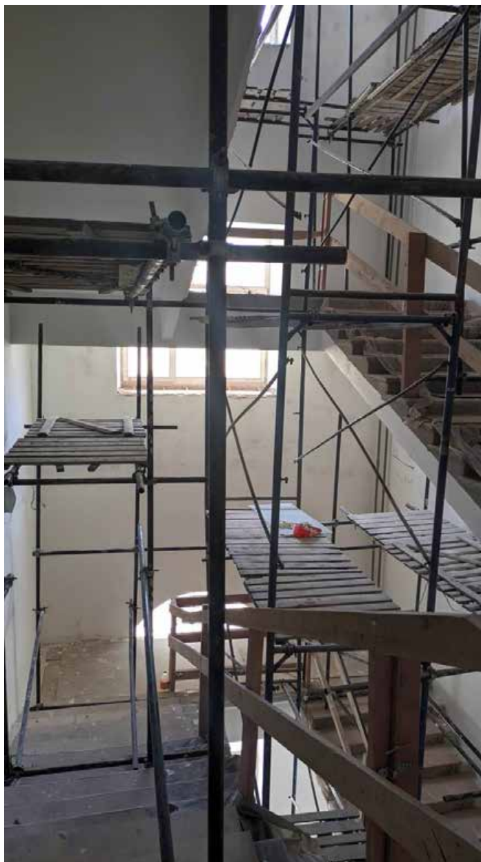
184. Вид на лестничную клетку зоны «Консерватория» в уровне 4-го этажа западного корпуса.
