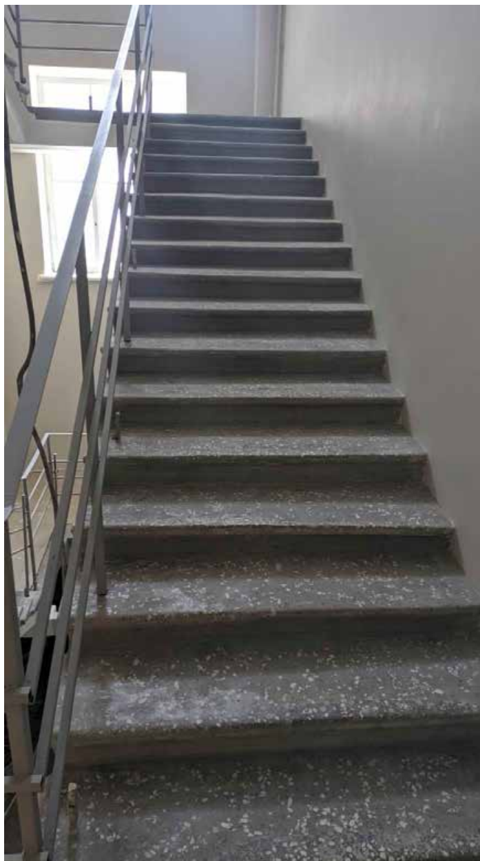
156. Вид на лестничную клетку зоны «Консерватория» в уровне 2-го этажа западного корпуса.
