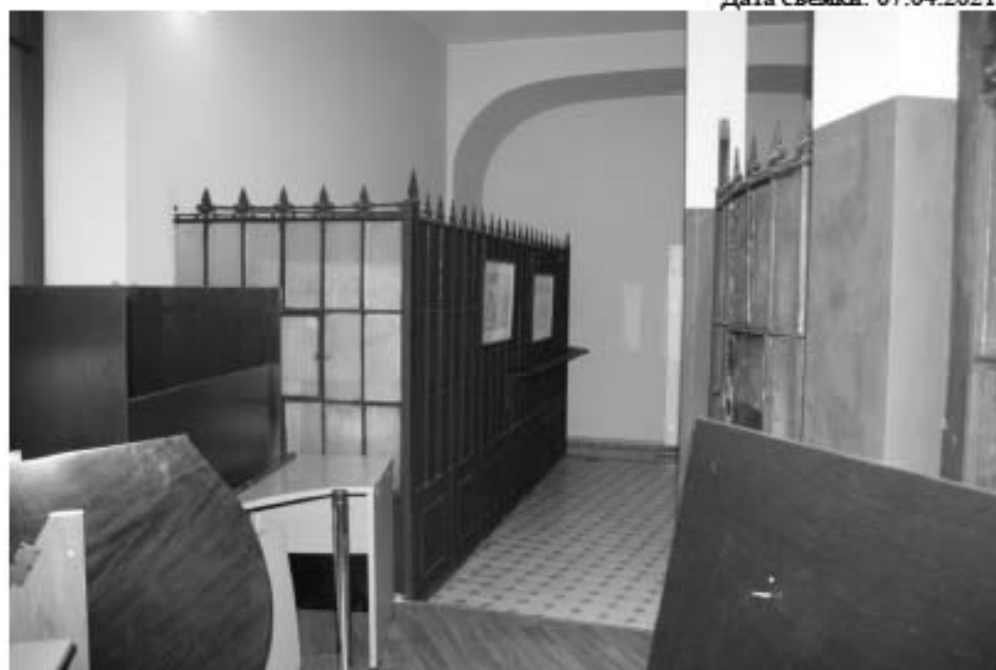
66. Помещение 1-Н (бывший «Операционный зал»). Перегородки между пилонами, с остеклением бесцветным офактуренным стеклом с рисунком «мороз»; стойки с остроконечными завершениями. Объект культурного наследия федерального значения «Дом, где в первой половине XIX в. размещалась Российско-Американская компания. Здесь в 1820-х гг. жили декабристы Бестужев-Марлинский А.А. и Рылеев К.Ф.», расположенный по адресу: Санкт-Петербург, Адмиралтейский район, набережная реки Мойки, дом 72, литера А. Дата съемки: 07.04.2021.
