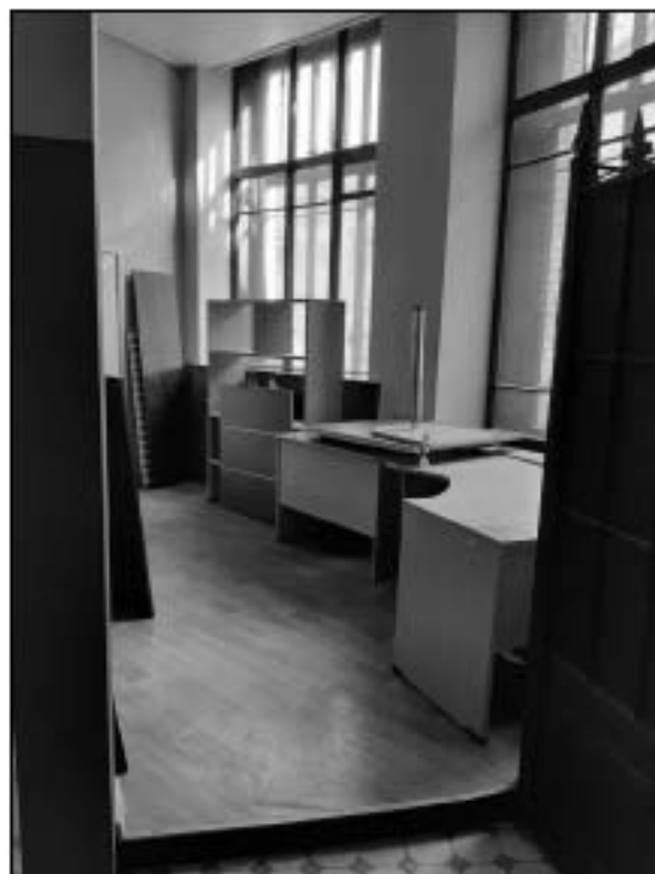
36. Второй этаж. Служебное помещение. Объект культурного наследия федерального значения «Дом, где в первой половине XIX в. размещалась Российско-Американская компания. Здесь в 1820-х гг. жили декабристы Бестужев-Марлинский А.А. и Рылеев К.Ф.», расположенный по адресу: Санкт-Петербург, Адмиралтейский район, набережная реки Мойки, дом 72, литера А. Дата съемки: 07.04.2021.
