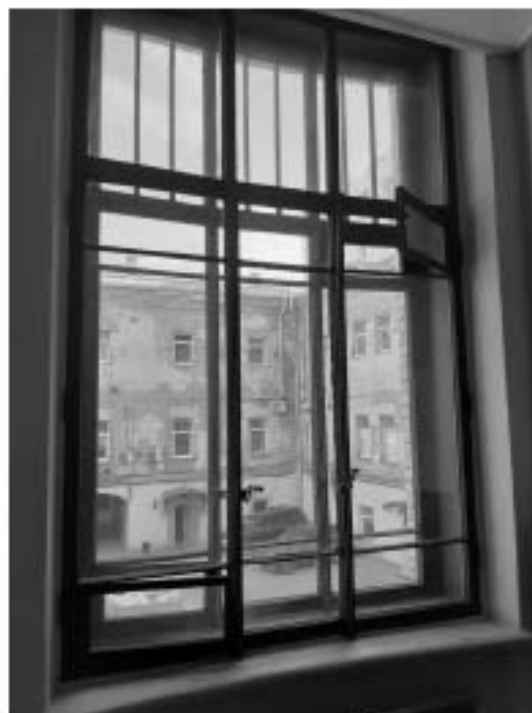
23. Оконные заполнения второго этажа. Объект культурного наследия федерального значения «Дом, где в первой половине XIX в. размещалась Российско-Американская компания. Здесь в 1820-х гг. жили декабристы Бестужев-Марлинский А.А. и Рылеев К.Ф.», расположенный по адресу: Санкт-Петербург, Адмиралтейский район, набережная реки Мойки, дом 72, литера А. Дата съемки: 07.04.2021.
