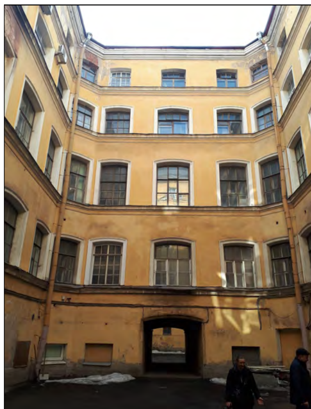
25. Объект культурного наследия «Корпус для прислуги», в составе комплекса «Дворец Великого князя Николая Николаевича (Ксенинский институт)», расположенного по адресу: г. Санкт-Петербург, площадь Труда, дом 4, литера А. Южная часть северного внутреннего двора. Северный фасад дворового корпуса. Вид на юго-восток. 20.04.2021 г.
