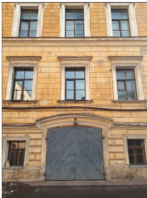
21. Объект культурного наследия «Корпус для прислуги», в составе комплекса «Дворец Великого князя Николая Николаевича (Ксенинский институт)», расположенного по адресу: г. Санкт-Петербург, площадь Труда, дом 4, литера А. Фрагмент южной части западного лицевого фасада. Вид на восток. 20.04.2021 г.
