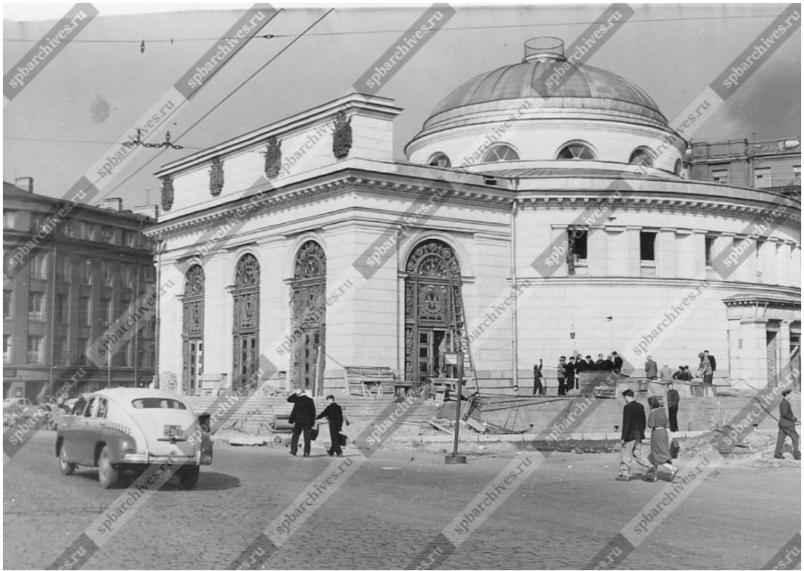
Илл. 9. Строительство станции метро «Нарвская» Ленинградского метрополитена имени В.И. Ленина. 10 сентября 1955 г. ЦГАКФФД СПб. Фотодокумент Бр 51889.
