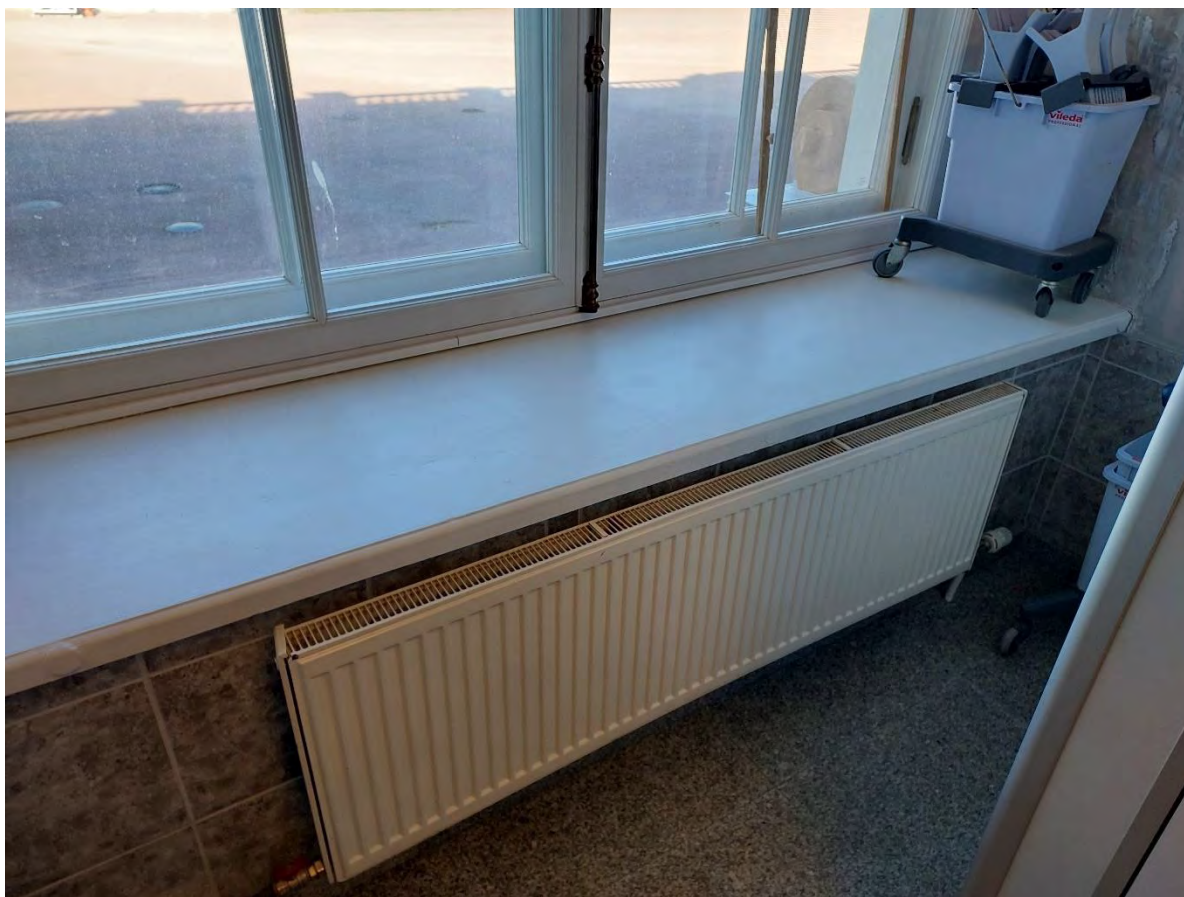
Илл. 27. Общий вид на радиатор в помещении №211.
