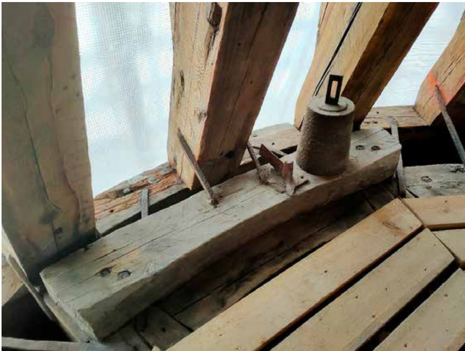
9. «Колокольня», входящая в состав объекта культурного наследия федерального значения «Собор Николо-Богоявленский (Морской)», Никольская пл., д. 1/3., лит. Б. Фрагмент колокольни. Фото 27.04.2022г.
