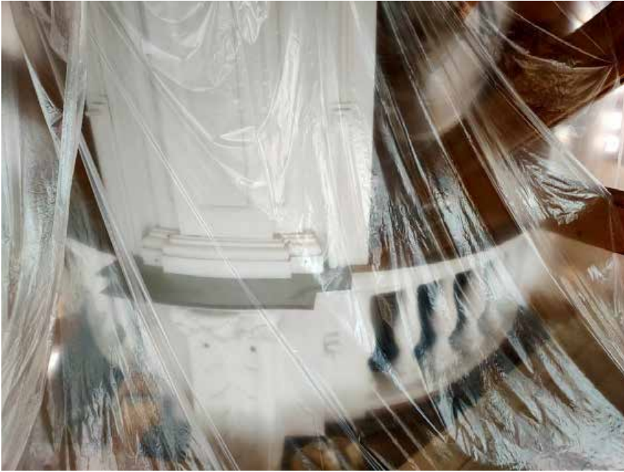
17. «Колокольня», входящая в состав объекта культурного наследия федерального значения «Собор Николо-Богоявленский (Морской)», Никольская пл., д. 1/3., лит. Б. Фрагмент колокольни. Фото 27.04.2022г.
