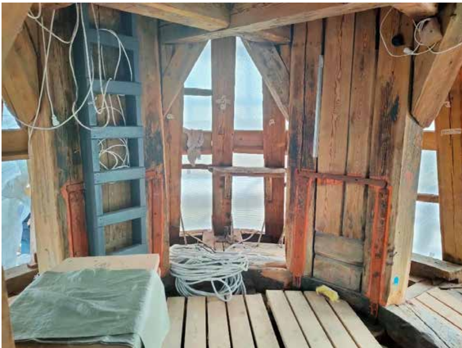
8. «Колокольня», входящая в состав объекта культурного наследия федерального значения «Собор Николо-Богоявленский (Морской)», Никольская пл., д. 1/3., лит. Б. Фрагмент колокольни. Фото 27.04.2022г.
