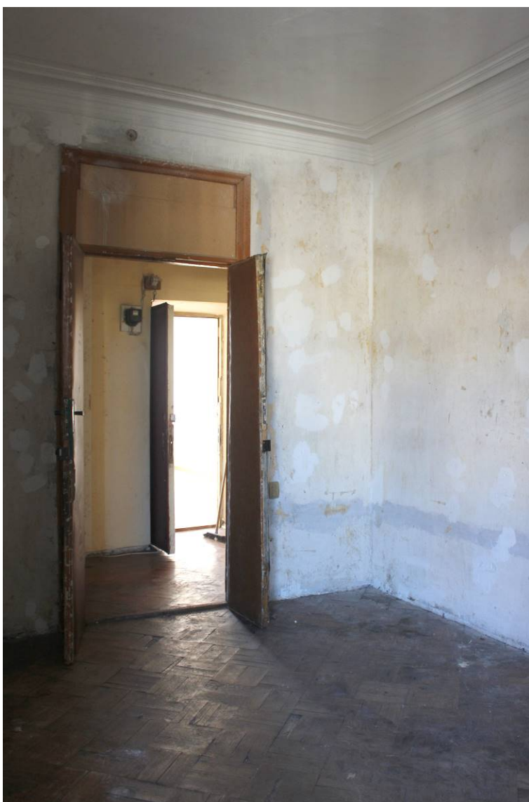
27. Выявленный объект культурного наследия «Дом И.И. Боргмана», по адресу: г. Санкт-Петербург, Съезжинская улица, дом 4, литера А. Квартира №4. Помещение 4. Общий вид помещения. Дата фотофиксации: 28 августа 2021 г.
