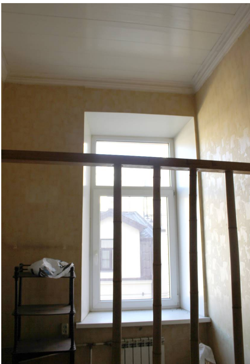
42. Выявленный объект культурного наследия «Дом И.И. Боргмана», по адресу: г. Санкт-Петербург, Съезжинская улица, дом 4, литера А. Квартира №4. Помещение 12. Общий вид помещения Дата фотофиксации: 28 августа 2021 г.
