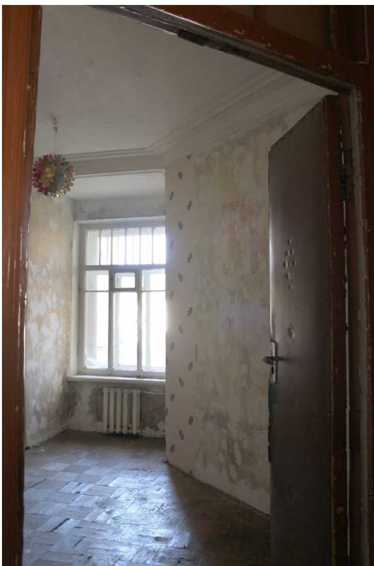
26. Выявленный объект культурного наследия «Дом И.И. Боргмана», по адресу: г. Санкт-Петербург, Съезжинская улица, дом 4, литера А. Квартира №4. Помещение 4. Общий вид из помещения 15. Дата фотофиксации: 28 августа 2021 г.
