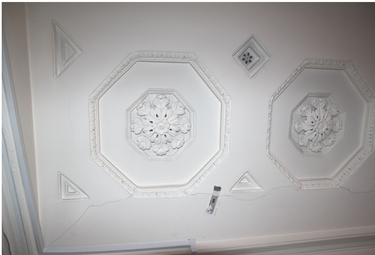
Фото 46. Потолок помещения №68. Кессоны, декорированные розетками. Трещина с маяком.
