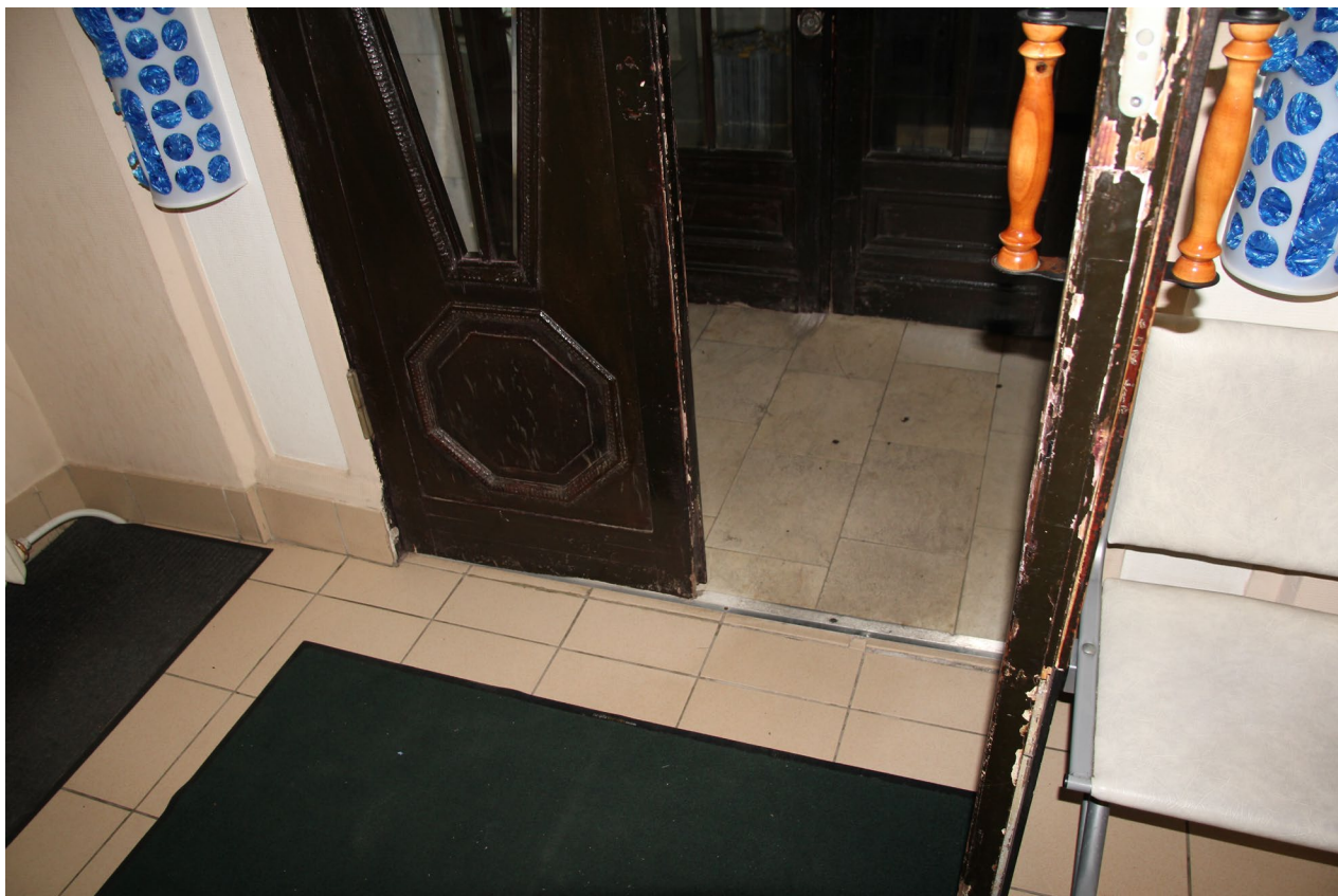
Фото 24. Помещение №43. Фрагмент дверного заполнения ДВ-1. Утрата лакокрасочного слоя, мех. повреждения древесины
