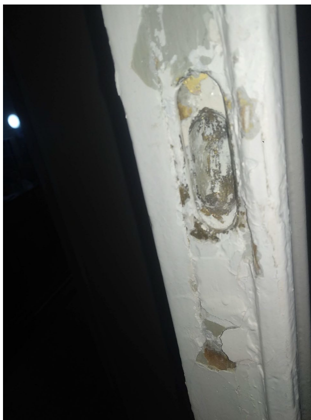
Фото 54. Фрагмент ДВ-6б. Утраты лакокрасочного слоя, механические повреждения древесины
