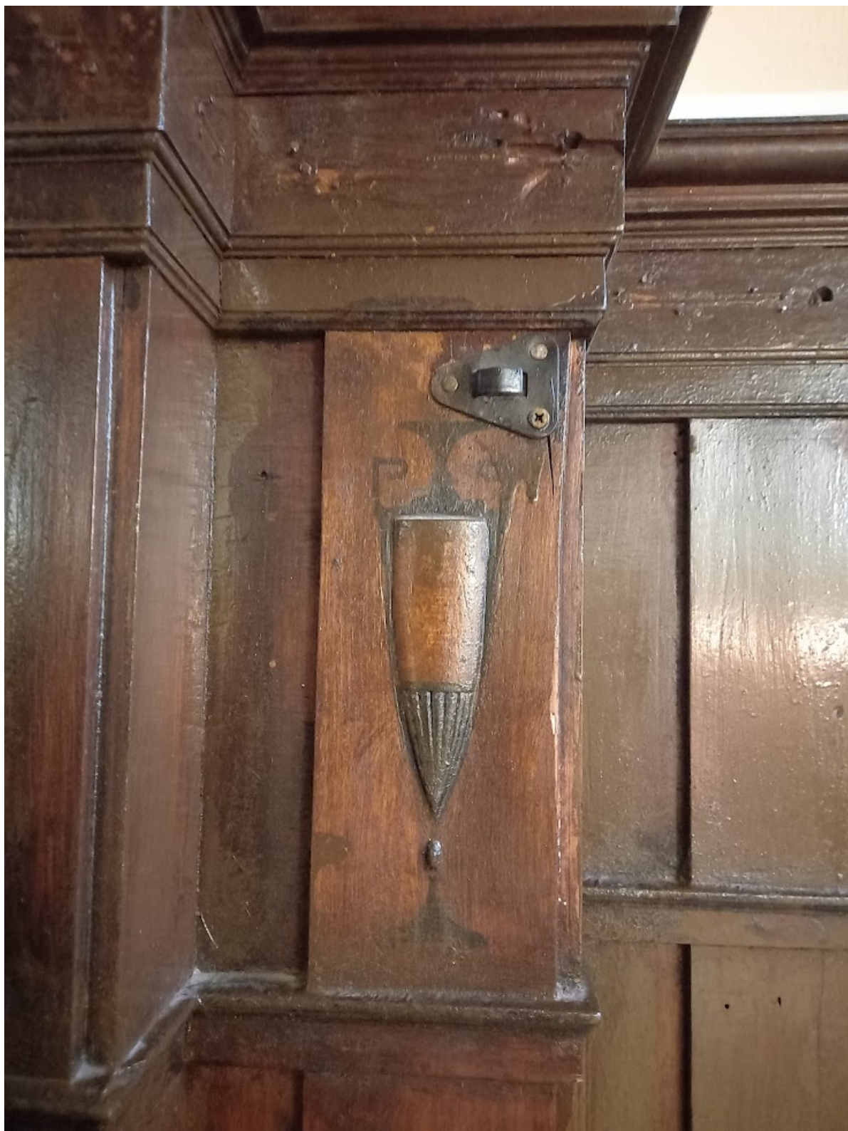
Фото 35. Помещение №43. Фрагмент отделки лестницы стеновыми панелями. Частичная утрата декоративного элемента (амфоры), механические повреждения древесины, поздние лакокрасочные поновления с подтеками.
