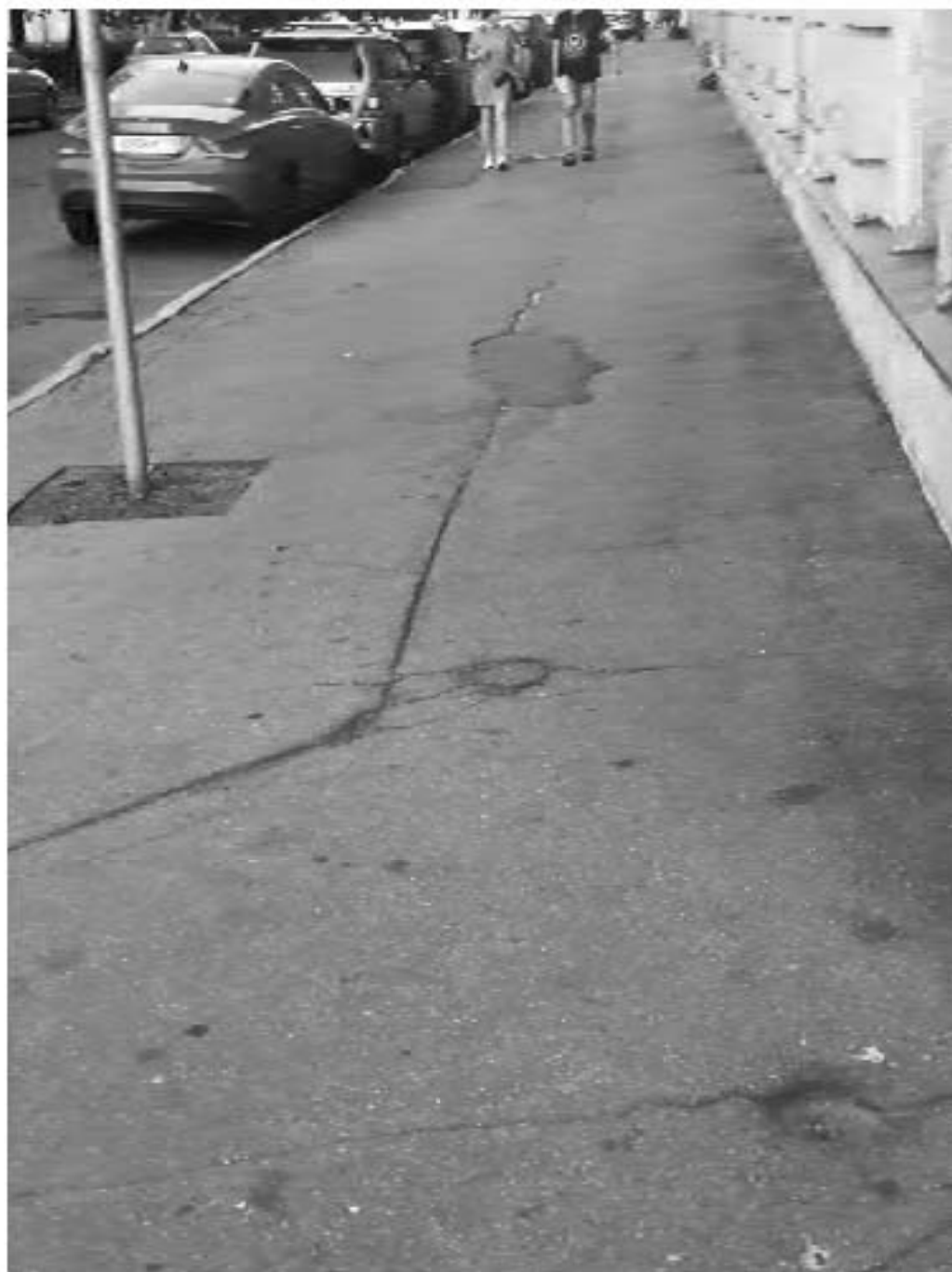
Фото №20. Фрагмент дорожного покрытия на пешеходной дорожке на Биржевой ул. вдоль дома по адресу Биржевая линия 16
