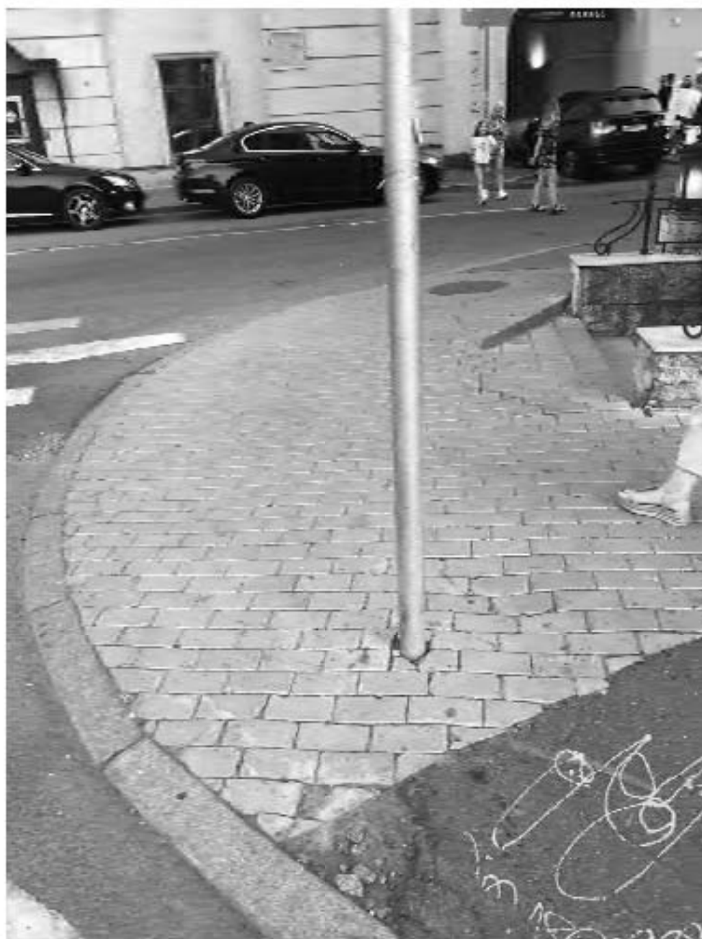
Фото №24. Мощение пешеходного тротуара на перекрестке Биржевого пер и Биржевой линии у дома по адресу Биржевой пер 1
