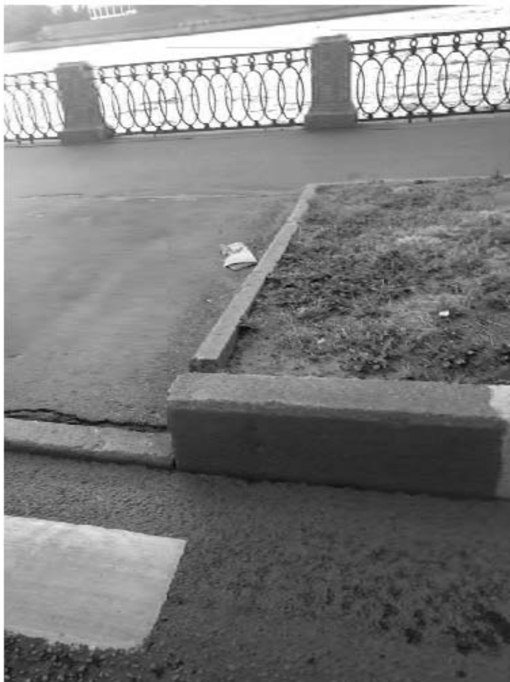
Фото №10. Фрагмент стыка бортовых камней у пешеходного перехода со стороны пешеходной части вдоль р. Малая Нева
