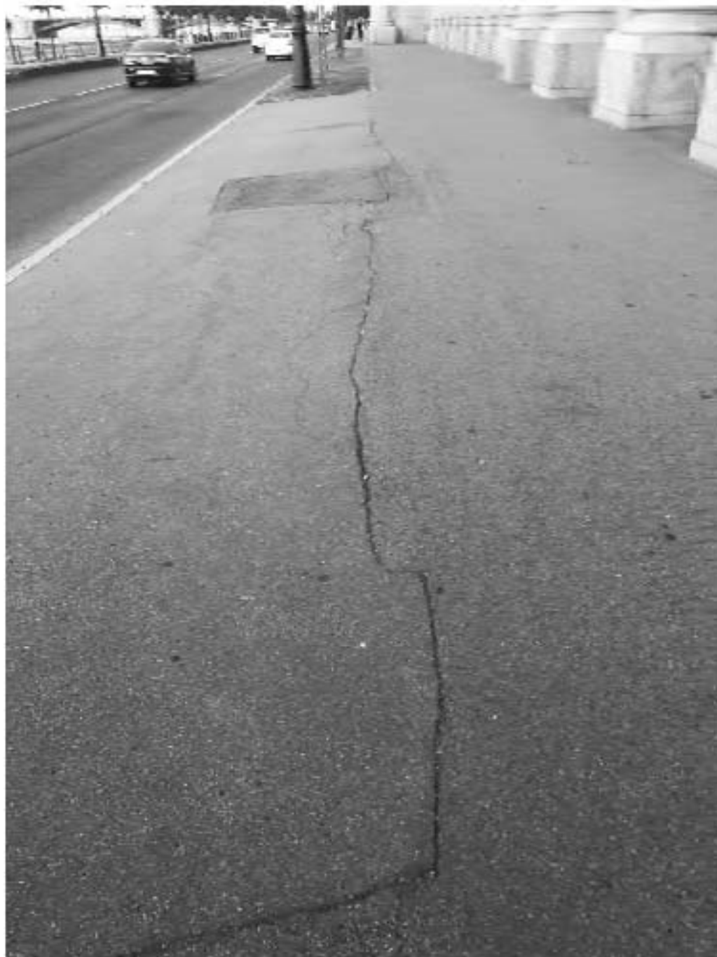
Фото №13. Фрагмент дорожного покрытия на пешеходной тротуаре вдоль дома по адресу наб. Макарова д.8
