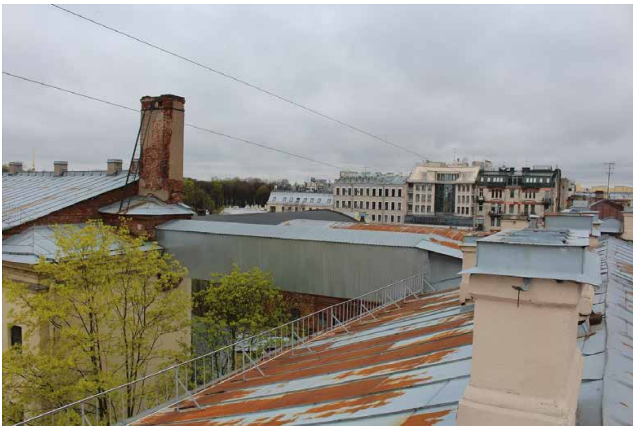
Фото 33. Вид на переход между лицевым корпусом и дворовым корпусом в северной части здания.
