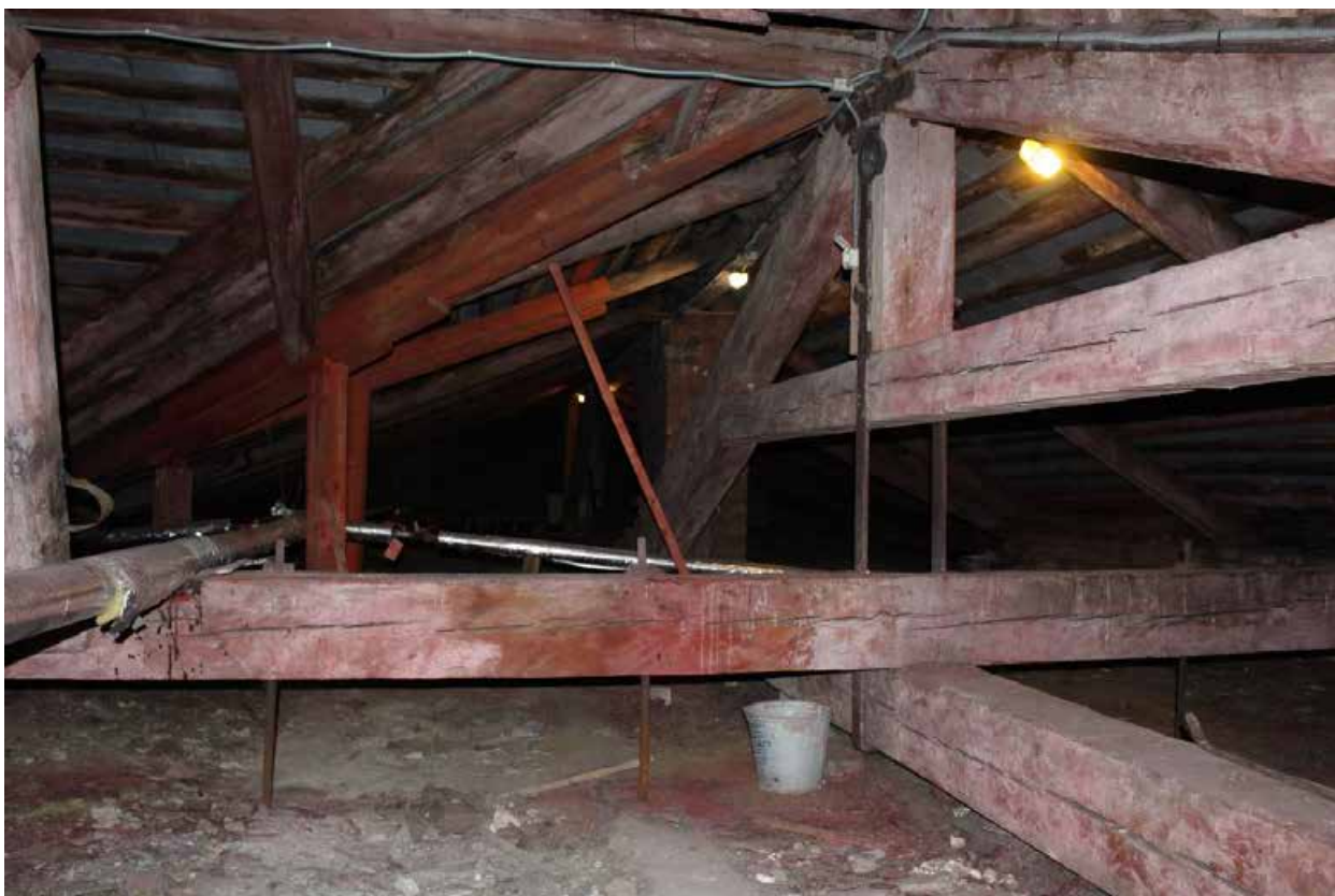
Фото 47. Вид на чердачные помещения дворового корпуса в северо-западной части объекта культурного наследия.
