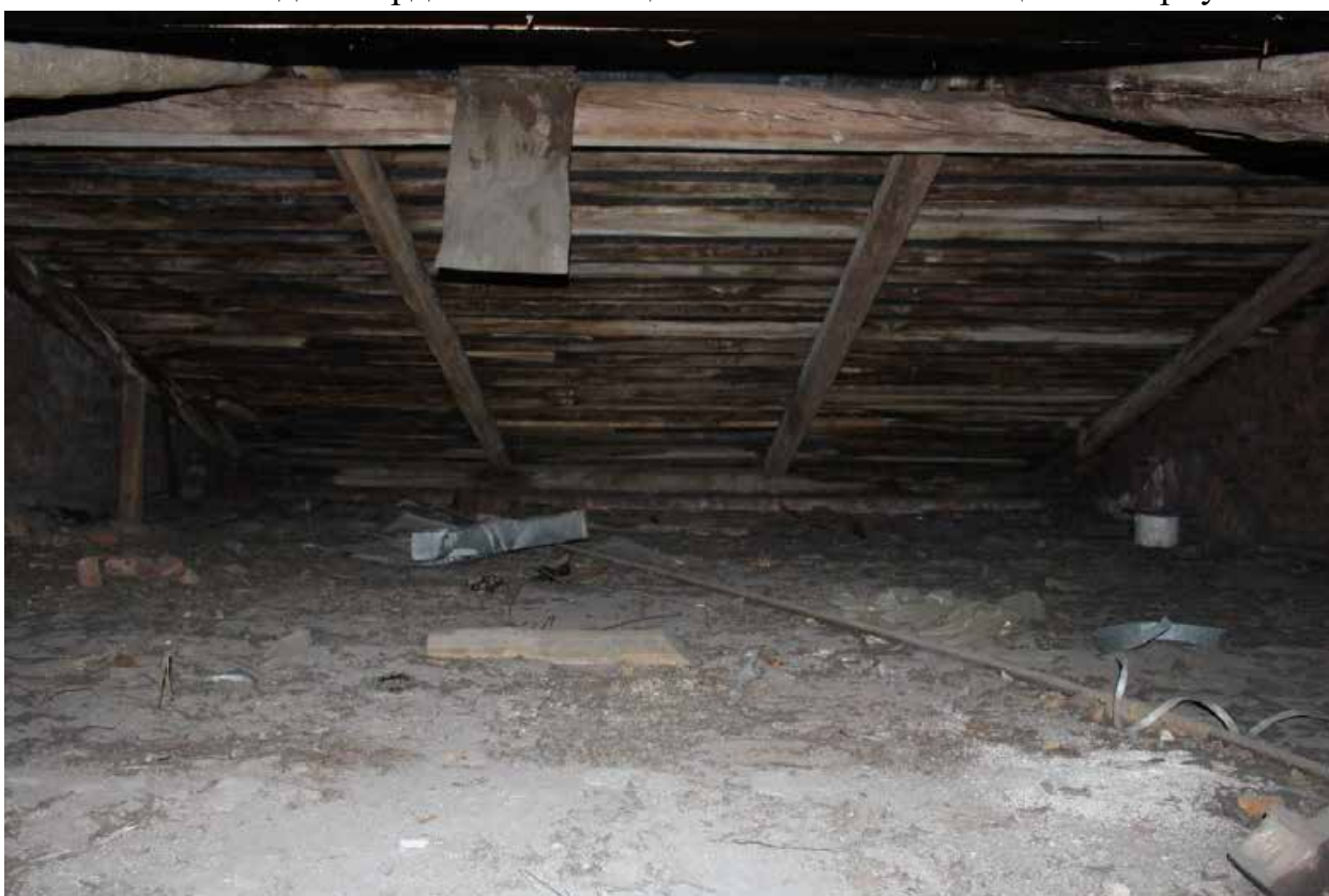
Фото 54. Вид на чердачные помещения лестницы в дворовом четырехэтажном корпусе, примыкающем к центральной части лицевого корпуса.
