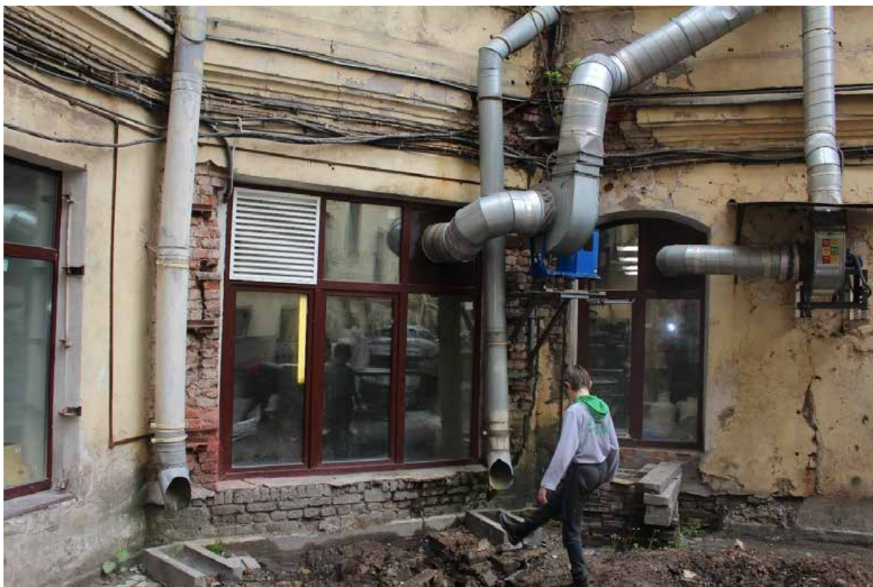
Фото 19. Вид на дворовые фасады в северо-западном углу северного двора в уровне 1-го этажа.
