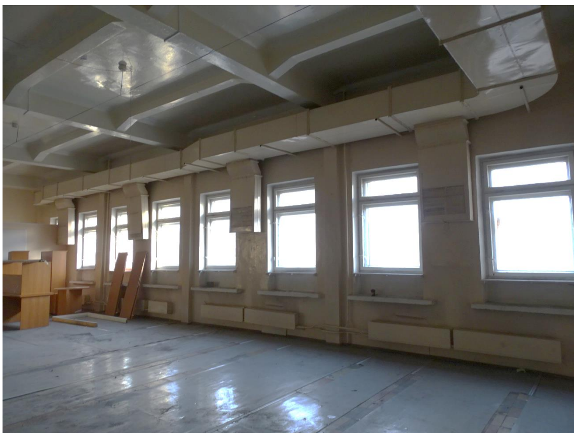
Фото 54. Выявленный объект культурного наследия «Здание Петроградской АТС» 3-й этаж. Пом. 18/291,7. Съемка 15.11.2021 г. Трушковский В.Э.
