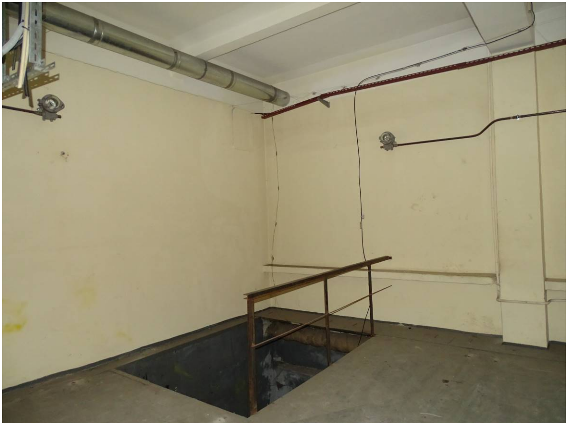
Фото 7. Выявленный объект культурного наследия «Здание Петроградской АТС» 1-й этаж. Пом. 8/254,5. Съемка 15.11.2021 г. Трушковский В.Э.
