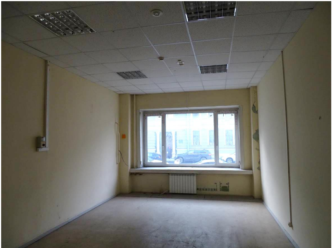
Фото 15. Выявленный объект культурного наследия «Здание Петроградской АТС» 1-й этаж. Пом. 8/254,5. Съемка 15.11.2021 г. Трушковский В.Э.
