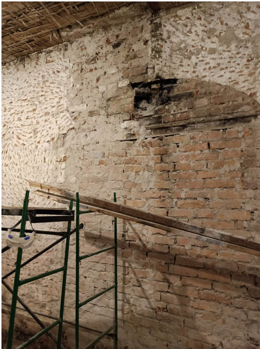
19. Казарма Офицерской стрелковой школы по адресу: г. Ломоносов, Владимирская ул., 15 Фрагмент интерьера 1-го этажа. Состояние кладки стены.
