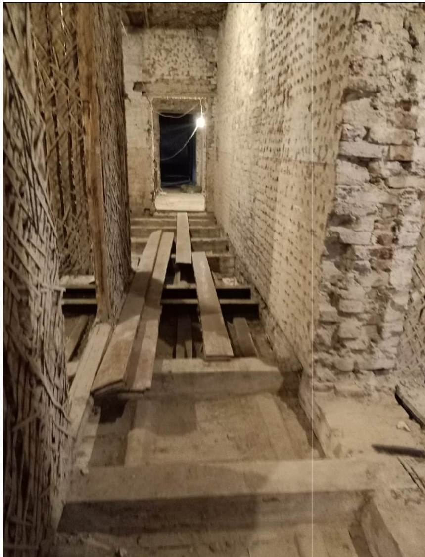
22. Казарма Офицерской стрелковой школы по адресу: г. Ломоносов, Владимирская ул., 15 Фрагмент интерьера 2-го этажа.
