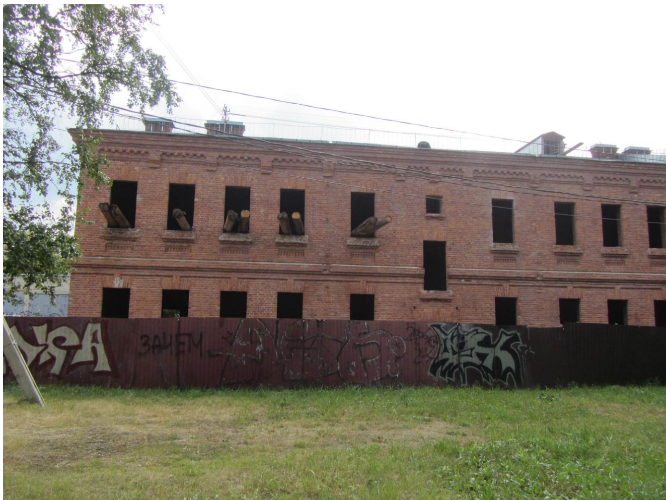
5. Казарма Офицерской стрелковой школы по адресу: г. Ломоносов, Владимирская ул., 16а. Восточная часть северного фасада.
