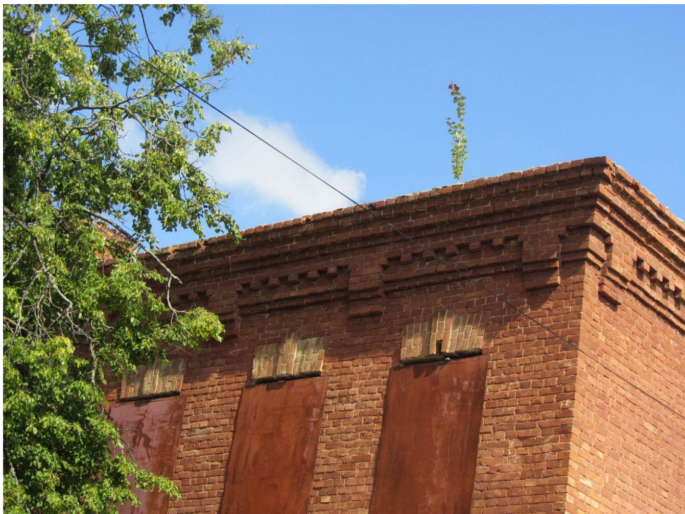
4. Казарма Офицерской стрелковой школы по адресу: г. Ломоносов, Владимирская ул., 16. Фрагмент лицевого фасада по Владимирской улице: венчающий карниз, оконные проемы 2-го этажа.
