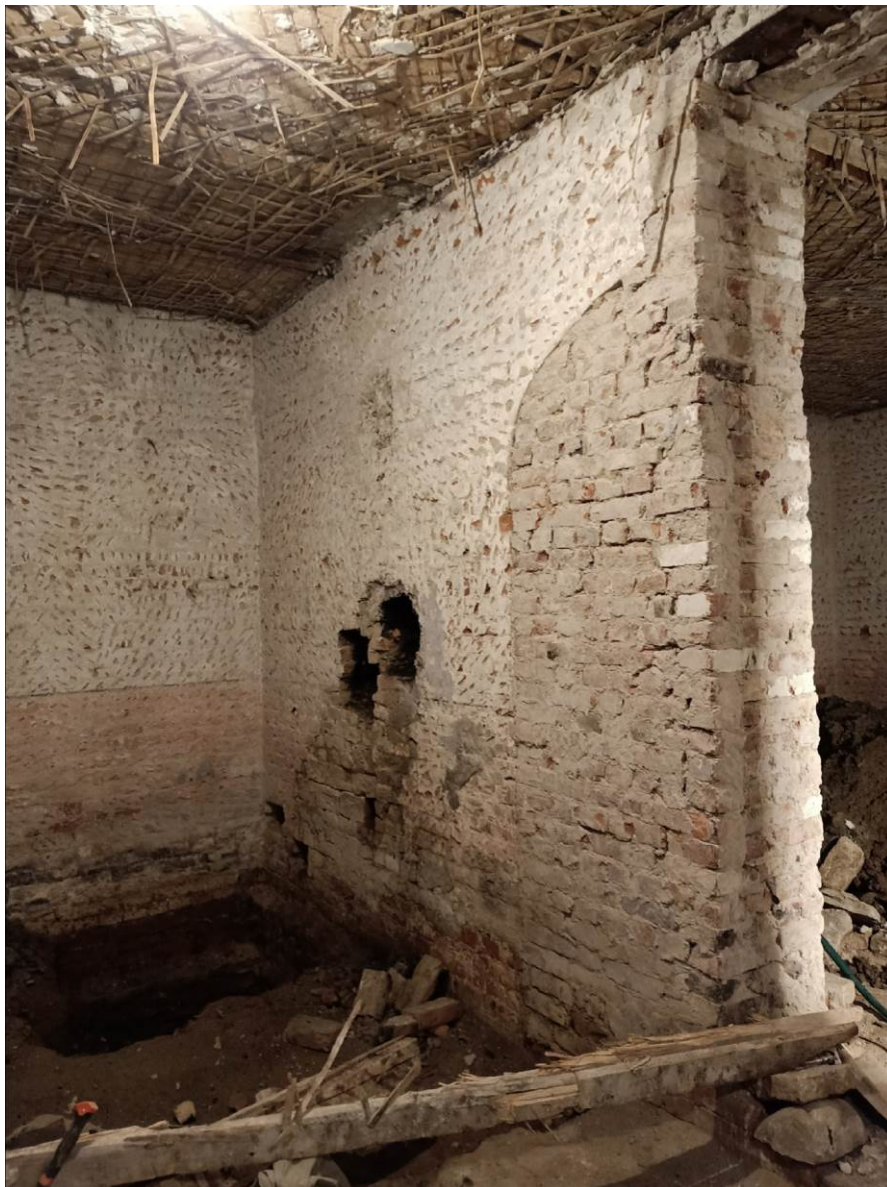
18. Казарма Офицерской стрелковой школы по адресу: г. Ломоносов, Владимирская ул., 15 Фрагменты торцевого фасада здания Фрагмент интерьера 1-го этажа. Состояние кладки стены.
