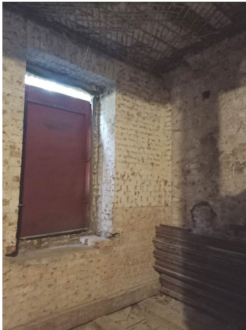
25. Казарма Офицерской стрелковой школы по адресу: г. Ломоносов, Владимирская ул., 15 Фрагмент интерьера 2-го этажа.
