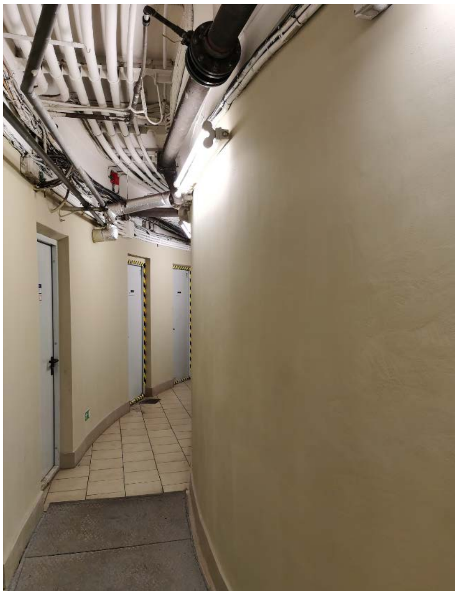
6. Помещение 1-Н (ч.п. 48) объекта культурного наследия регионального значения «Станция метро «Площадь Восстания» (с перронным залом)», расположенного по адресу: г. Санкт-Петербург, площадь Восстания, д. 2, литера А. 01.07.2022
