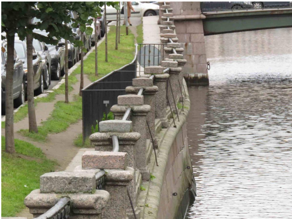
Фото 4. Набережная канала Грибоедова. Общий вид аварийного участка.
