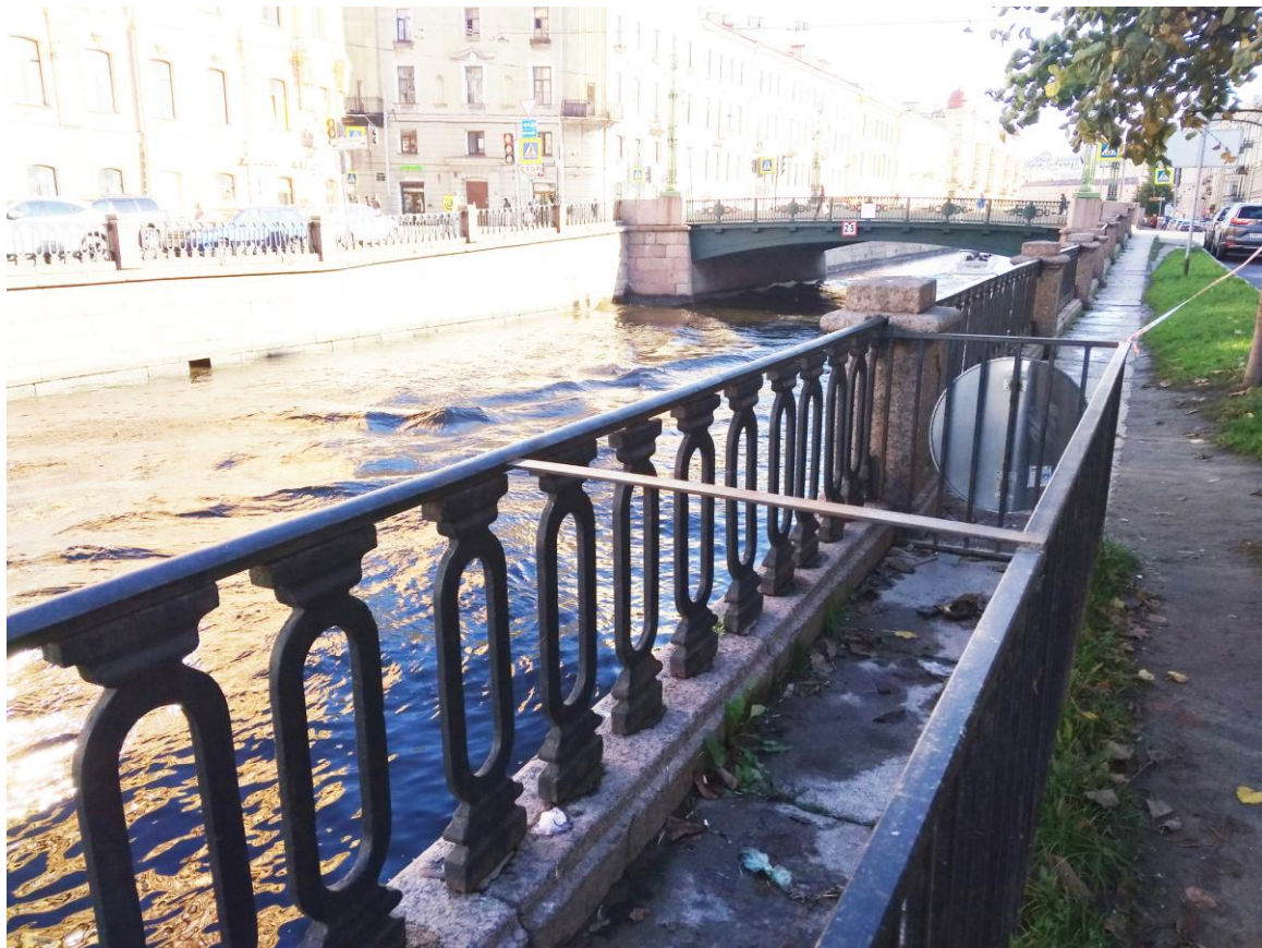
Фото 6. Набережная канала Грибоедова. Ограждение аварийного участка
