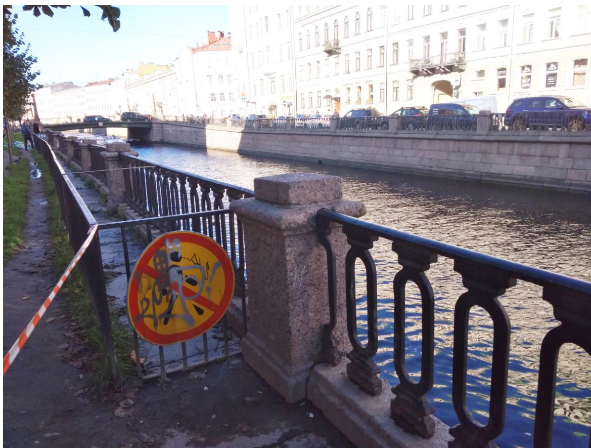
Фото 7. Набережная канала Грибоедова. Ограждение аварийного участка.
