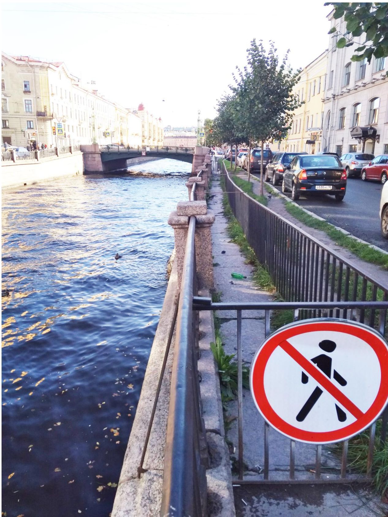
Фото 9 Набережная канала Грибоедова. Вид аварийного участка от Подъяческого моста.
