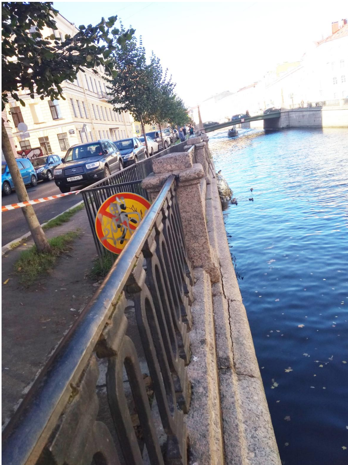
Фото 3. Набережная канала Грибоедова. Фрагмент аварийного участка.
