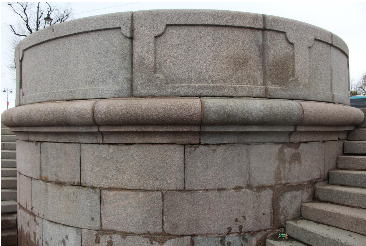
Фото 9. Вид на подпорную стенку и парапет верхнего яруса со стороны нижней площадки спуска № 4.
