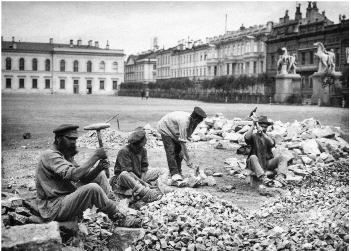
Илл. 21. Конногвардейский плац. Фотография 1900-х гг. (слева – часть корпуса «Казарм с коюшнями», южный фасад).
