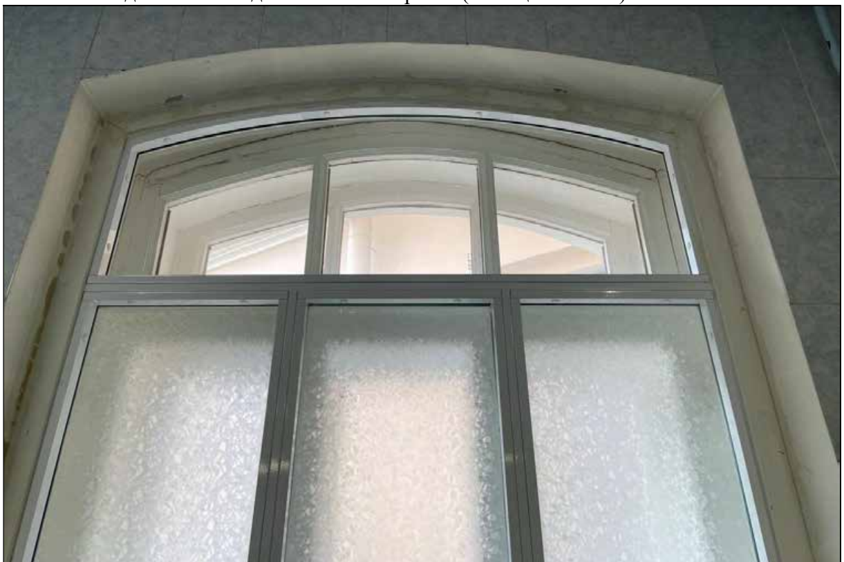
24. Главное здание (концертный зал с учебными флигелями). Помещения 2-го этажа литер А-7 (мужской зрительский санузел). Фрамуга западного оконного проема (помещение № 46). 08.07.2022 г.
