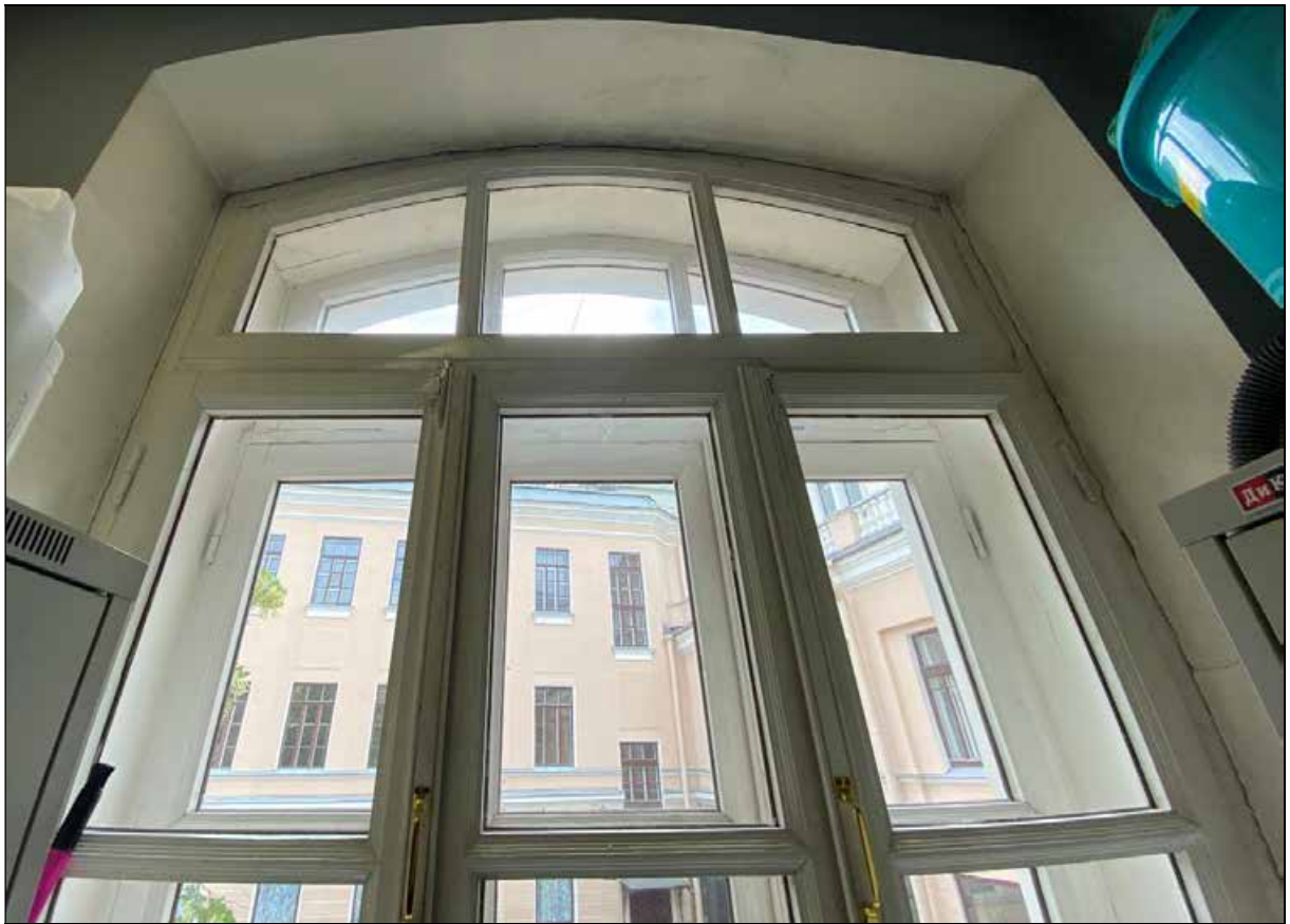
29. Главное здание (концертный зал с учебными флигелями). Помещения 2-го этажа литер А-7 (мужской зрительский санузел). Фрамуга восточного оконного проема (помещение № 51). 08.07.2022 г.
