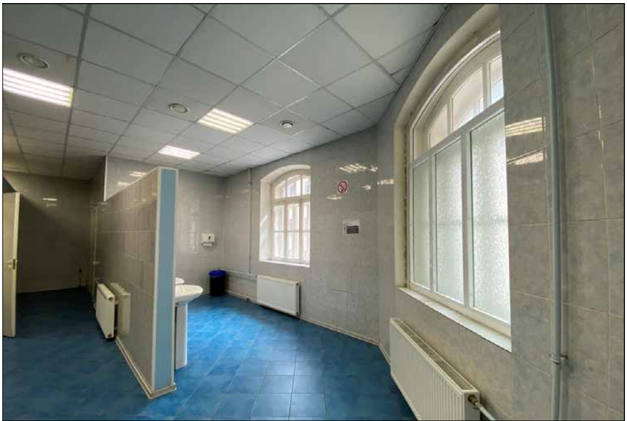
14. Главное здание (концертный зал с учебными флигелями). Помещения 2-го этажа литер А-7 (мужской зрительский санузел). Оконные проемы в южной части помещения № 46. Вид от входа. 08.07.2022 г.
