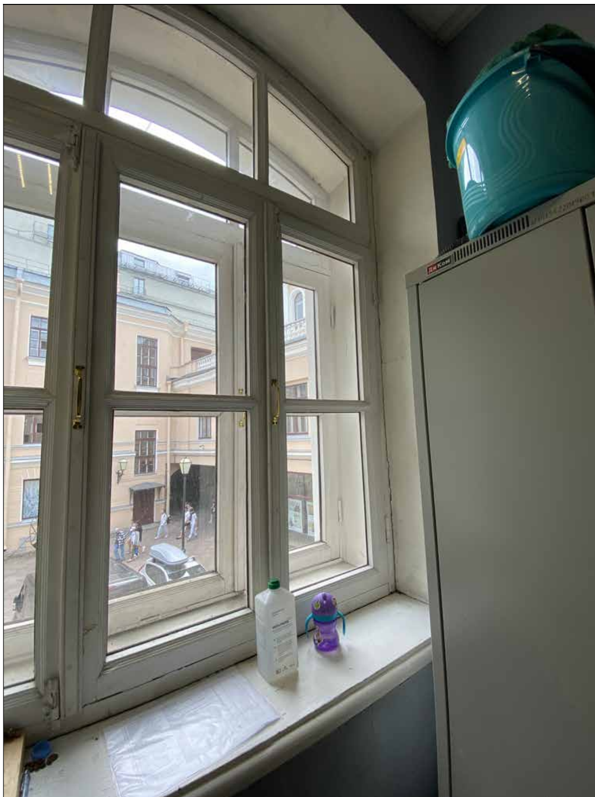
28. Главное здание (концертный зал с учебными флигелями). Помещения 2-го этажа литер А-7 (мужской зрительский санузел). Восточный оконный проем (помещение № 51). Фрагмент. 08.07.2022 г.
