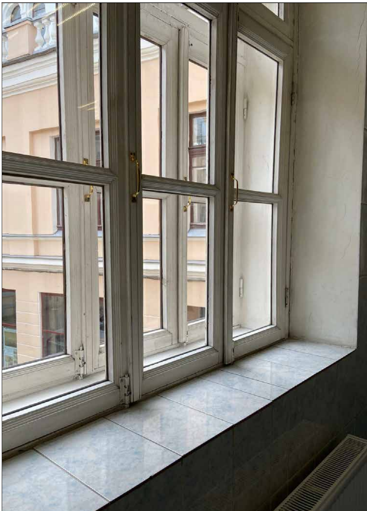
18. Главное здание (концертный зал с учебными флигелями). Помещения 2-го этажа литер А-7 (мужской зрительский санузел). Подоконник центрального оконного проема (помещение № 46). 08.07.2022 г.
