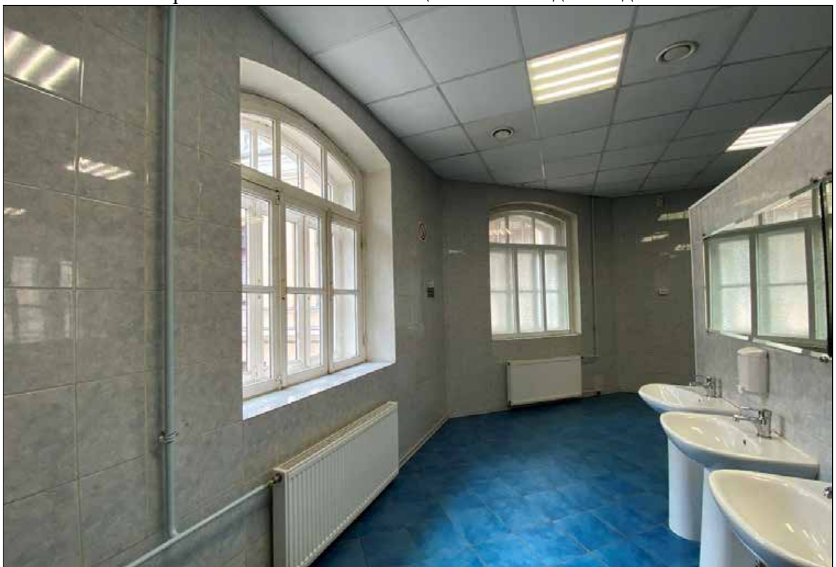
15. Главное здание (концертный зал с учебными флигелями). Помещения 2-го этажа литер А-7 (мужской зрительский санузел). Оконные проемы в южной части помещения № 46. Вид от помещения № 51. 08.07.2022 г.
