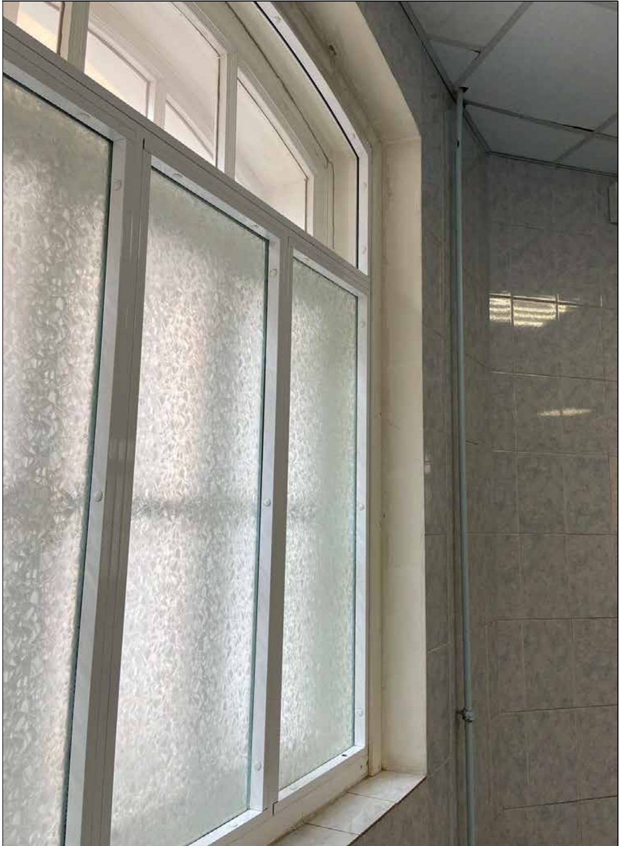
22. Главное здание (концертный зал с учебными флигелями). Помещения 2-го этажа литер А-7 (мужской зрительский санузел). Откос западного оконного проема (помещение № 46). 08.07.2022 г.
