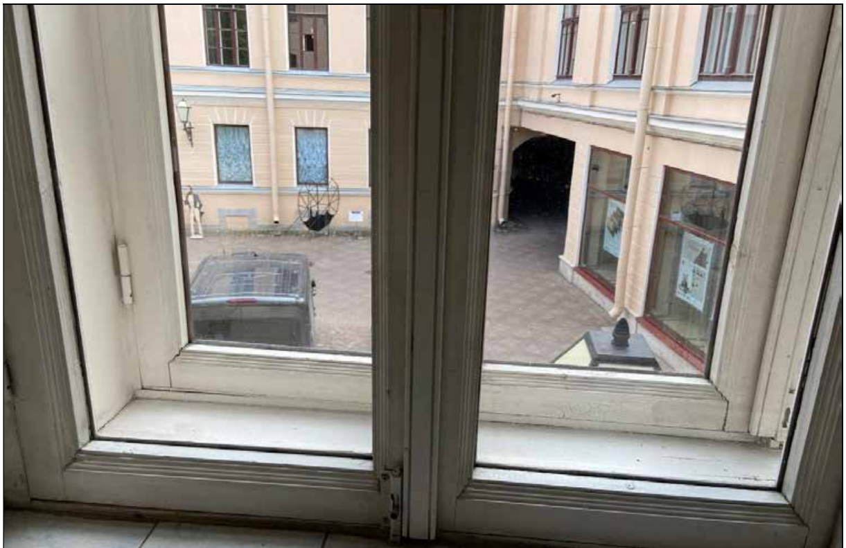
20. Главное здание (концертный зал с учебными флигелями). Помещения 2-го этажа литер А-7 (мужской зрительский санузел). Фрагмент деревянной рамы центрального оконного проема (помещение № 46). 08.07.2022 г.
