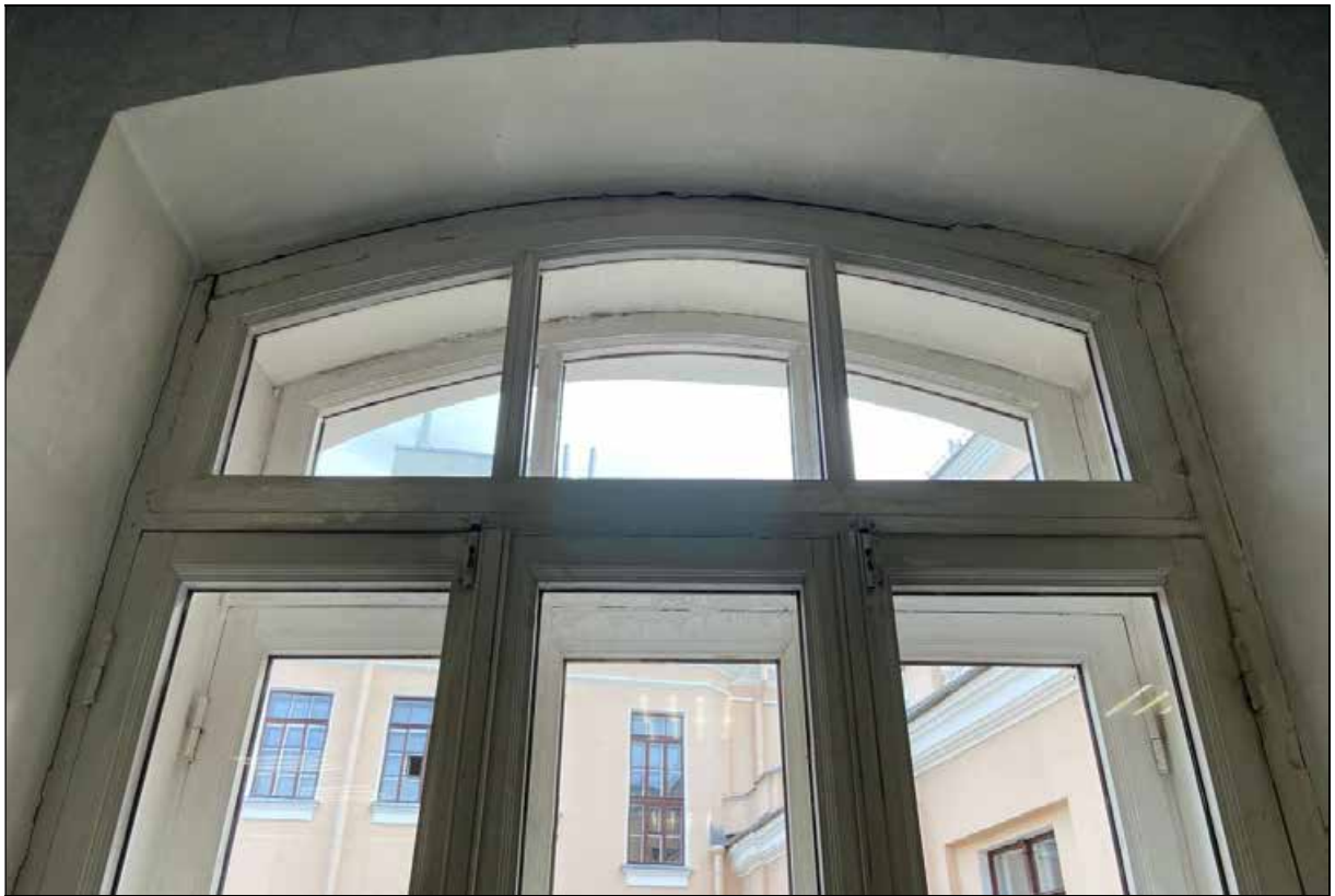
19. Главное здание (концертный зал с учебными флигелями). Помещения 2-го этажа литер А-7 (мужской зрительский санузел). Фрамуга центрального оконного проема (помещение № 46). 08.07.2022 г.
