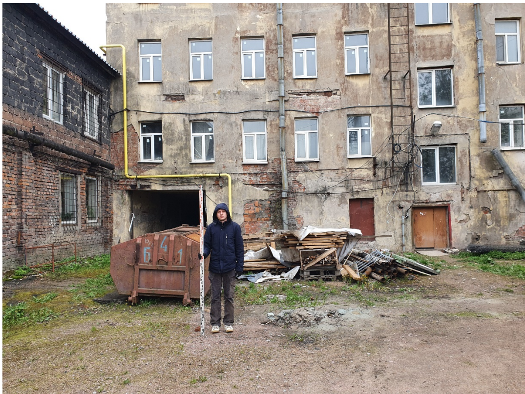
Рис. 17. СПб-2022. Московский район. Булавского ул., д. 6. Общий вид участка обследования. Шурф 1. Да начала работ. Вид с юго-востока.
