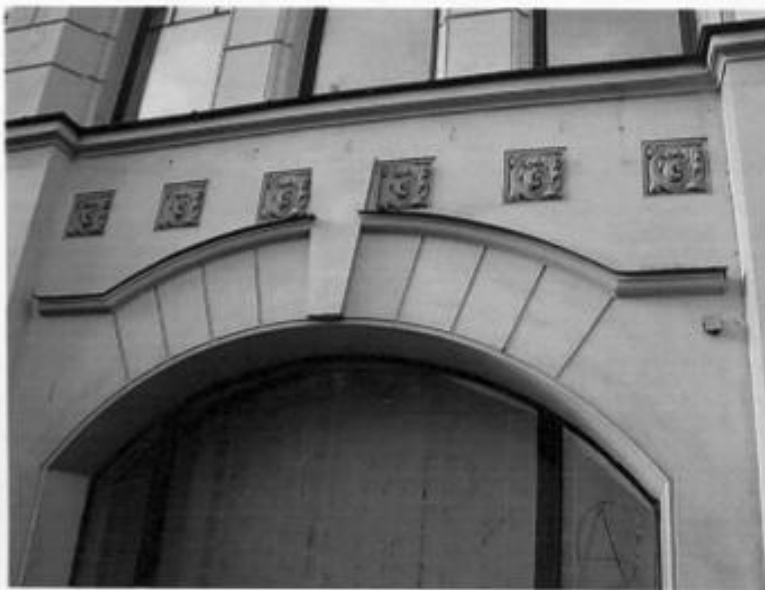
Лицевой фасад по Каменноостровскому пр., оконный проем с коробовым завершением пом. 2-Н, декор. Съемка 11.10.2010г. Е.А.Алехина
