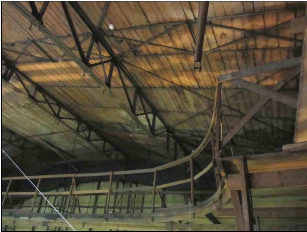
68. Здание «Петербургского центрального рынка», входящего в «Комплекс общественных и жилых зданий Г.А.Александрова (Каменноостровский пр., 10, 12, лит. А)». Фрагмент интерьера. (Фото 17.12.2021 г.)
