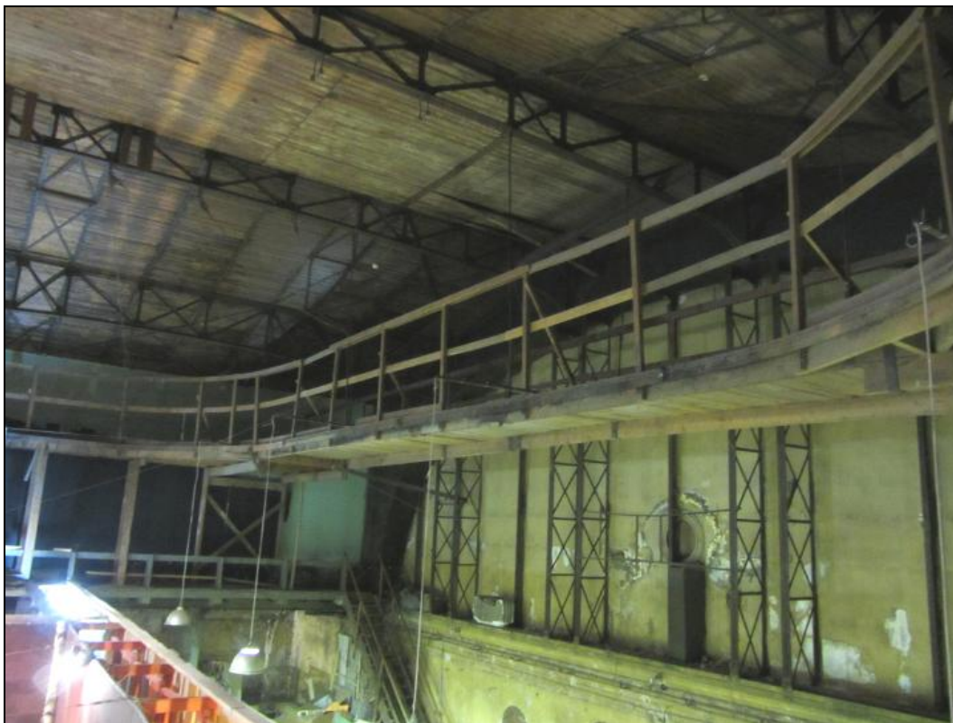
66. Здание «Петербургского центрального рынка», входящего в «Комплекс общественных и жилых зданий Г.А.Александрова (Каменноостровский пр., 10, 12, лит. А)». Фрагмент интерьера. Вид на торцевую стену. (Фото 17.12.2021 г.)
