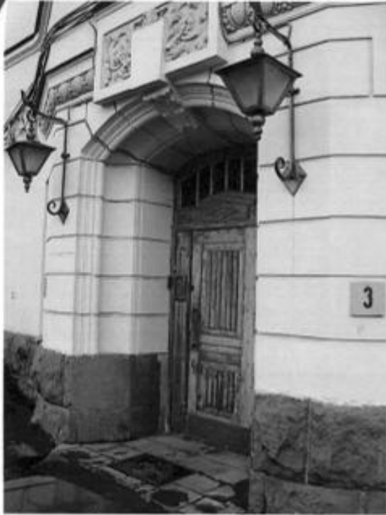
Фрагмент фасада курдонера с парадным входом в помещения 13-Н (дверное заполнение) Съемка 11.10.2010г. Е.А.Алехина
