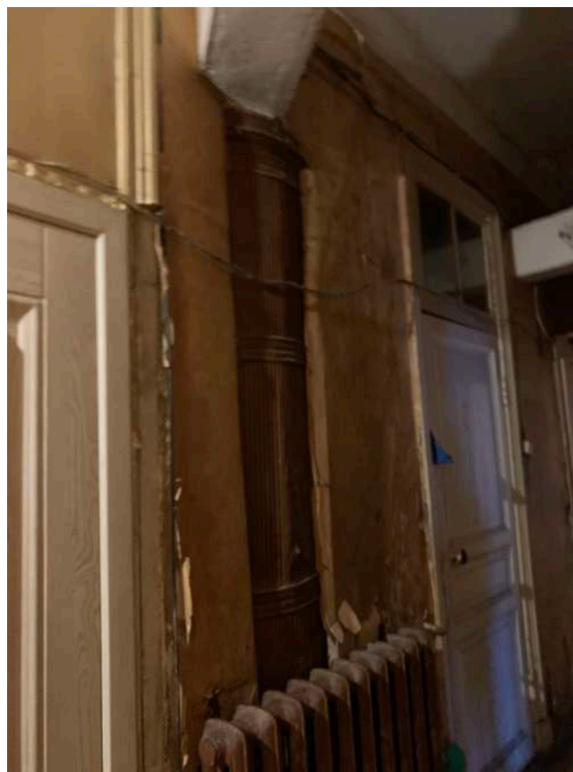
Фото №12. Фрагмент стены помещения коридора (пом.№10 согласно плану ПИБ)
