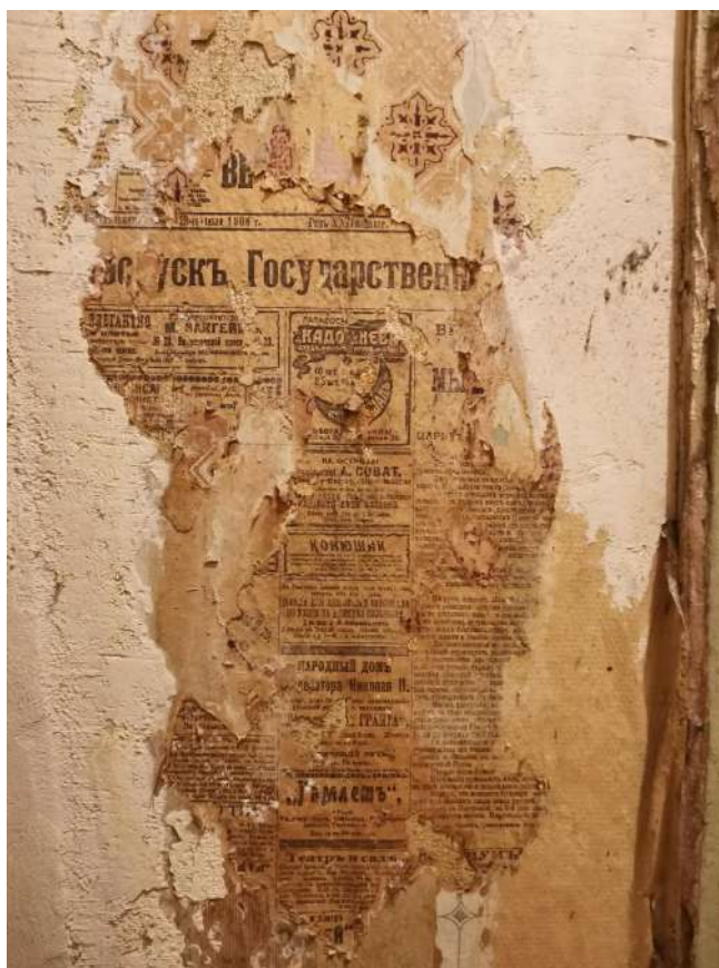
Фото №14. Фрагмент стены коридора (пом.№6 согласно плану ПИБ)
