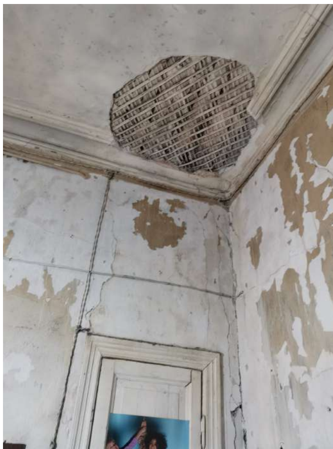
Фото №6. Фрагмент потолка помещения кухни (пом.№7 согласно плану ПИБ)
