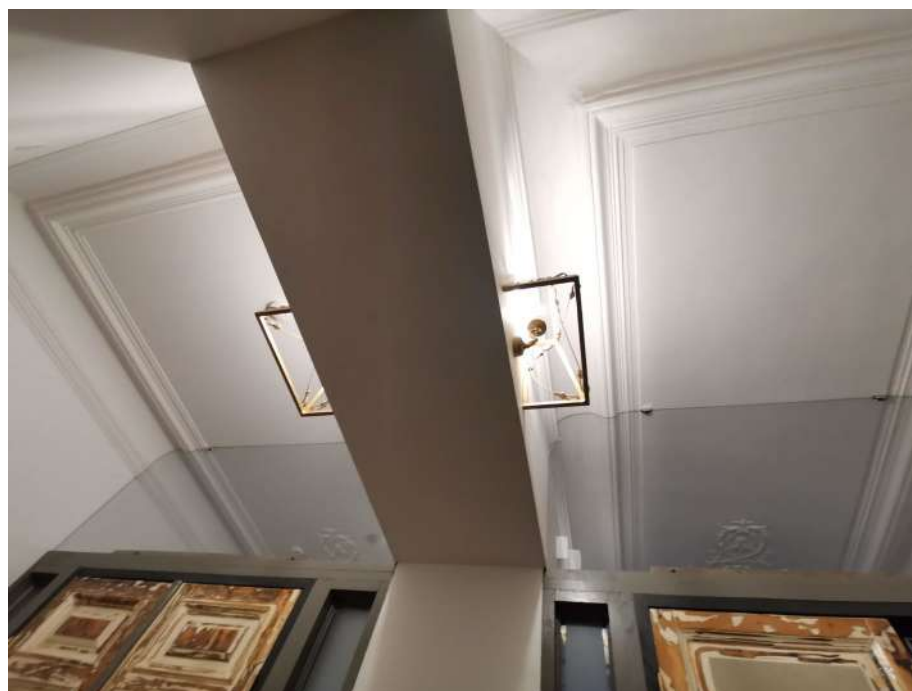
Фото 8. Лепное оформление с профилированной падугой, зеркалом потолка и розетками сложного рисунка под люстру.
