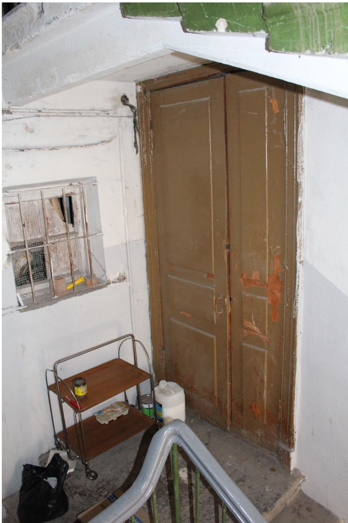
Фото 48. Вид на входную дверь в квартиру № 11 со служебной лестницы (ЗЛК).
