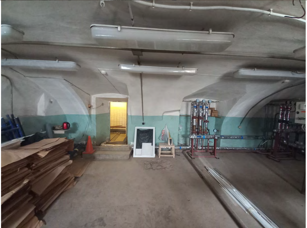
Фото 15 и 16. Помещение 21. Теплоцентр.
