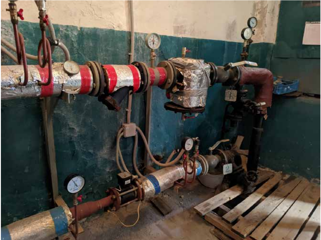
Фото 1. ИТП в помещении 17-Н в здании по адресу: г. Санкт-Петербург, 4-я линия, 35-37. Ввод теплосети в полу цокольного этажа.
