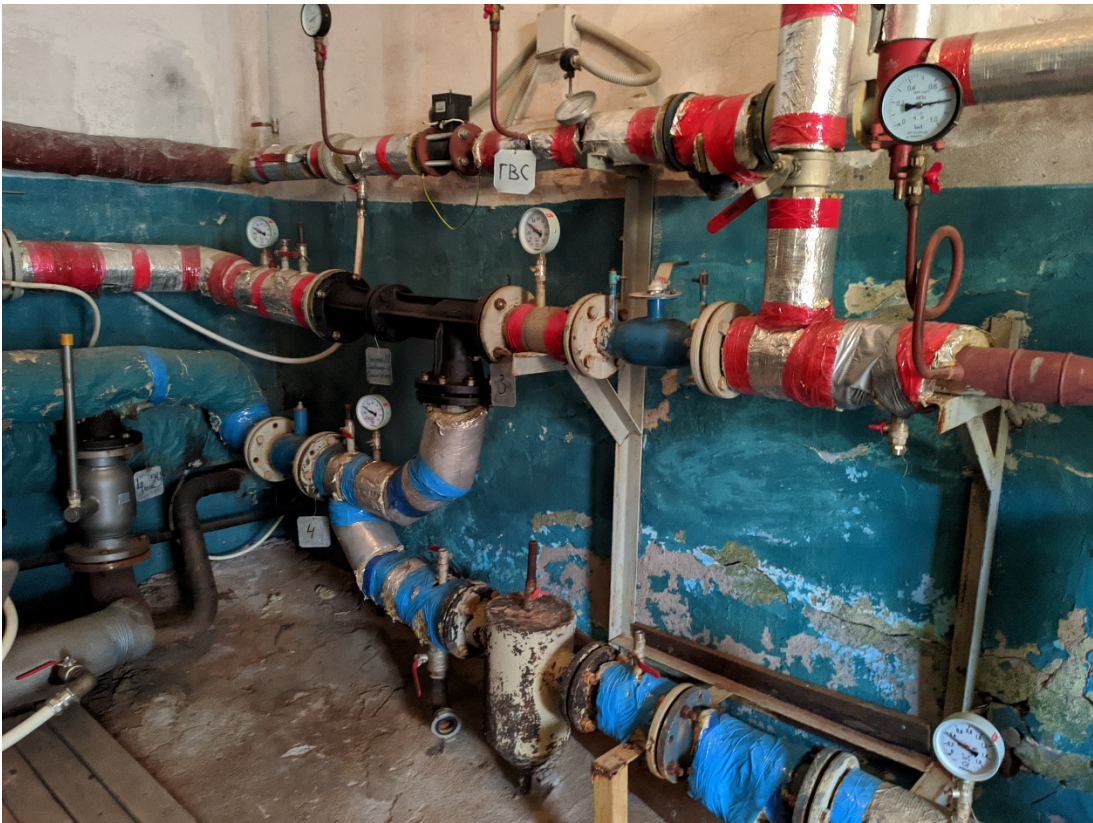
Фото 3. ИТП в помещении 17-Н в здании по адресу: г. Санкт-Петербург, 4-я линия, 35-37
