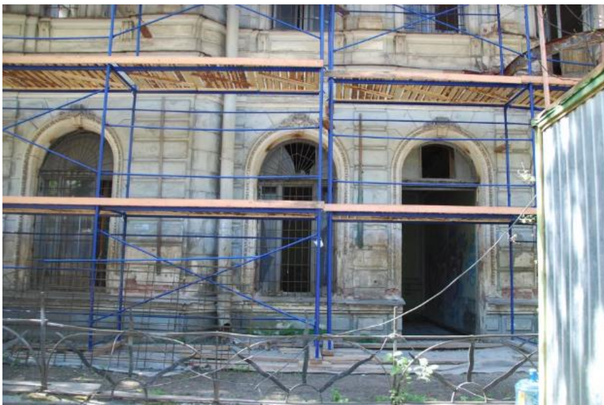
20. Восточный лицевой фасад объекта культурного наследия регионального значения «Усадьба Игеля Э.Г.», расположенного по адресу: г. Санкт-Петербург, Каменноостровский пр., д. 58-60, литера А. Фрагмент. 15.07.2022
