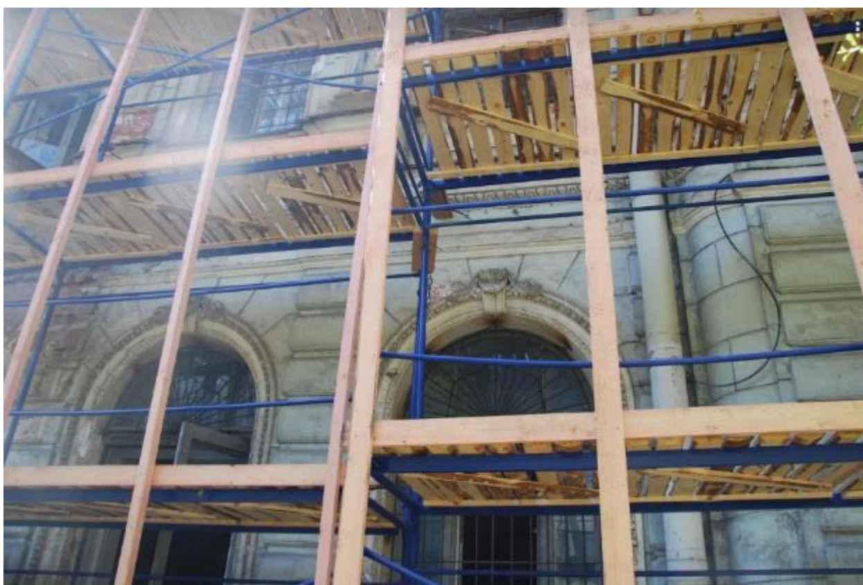
19. Восточный лицевой фасад объекта культурного наследия регионального значения «Усадьба Игеля Э.Г.», расположенного по адресу: г. Санкт-Петербург, Каменноостровский пр., д. 58-60, литера А. Фрагмент. 15.07.2022
