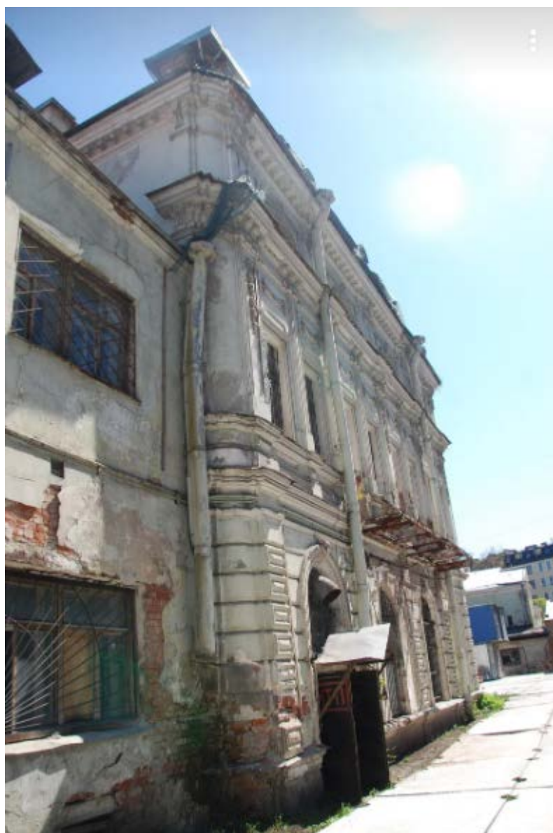
31. Западный фасад объекта культурного наследия регионального значения «Усадьба Игеля Э.Г.», расположенного по адресу: г. Санкт-Петербург, Каменноостровский пр., д. 58-60, литера А. Фрагмент. 15.07.2022
