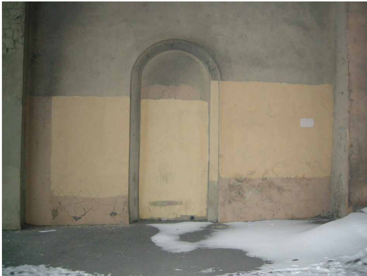
46. Объект культурного наследия регионального значения «Комплекс жилых домов (6 зданий)», расположенный по адресу: Санкт-Петербург, Красногвардейский район, Малоохтинский пр., 86, лит. А Ниша с полуциркульным завершением в стене центрального проезда Съемка: 14 декабря 2020 г.
