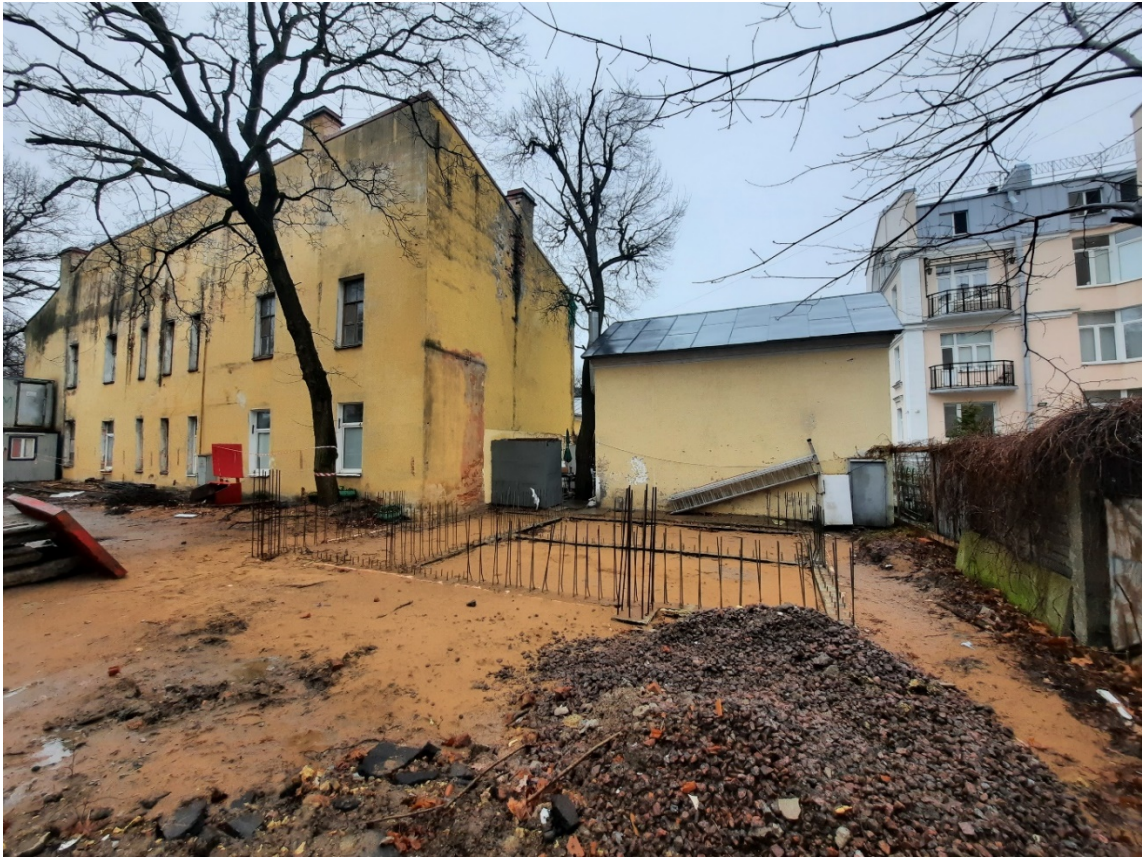
Фото 1. Реконструируемое здание по адресу: г. Санкт-Петербург, город Петергоф, улица Аврова, дом 5, литера Б и объект культурного наследия федерального значения «Почта»
