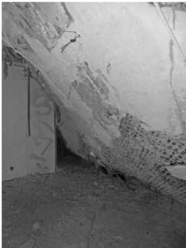
Фото 13. Помещение 20, обрушение перекрытия.
