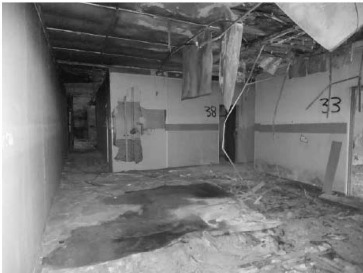
Фото 43. Помещение центрального корпуса, разрушение перекрытия.
