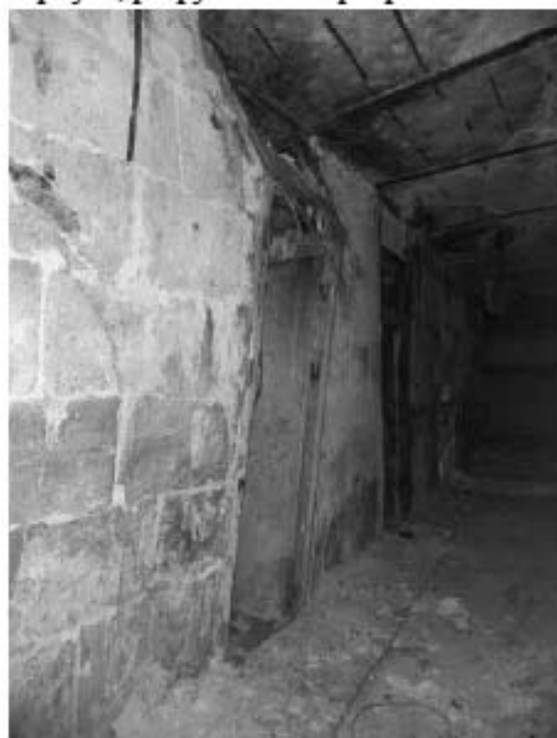
Фото 45. Коридор центрального корпуса, разрушение перекрытия.
