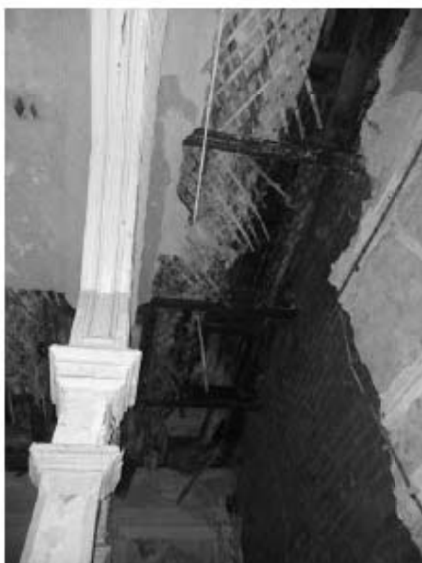
Фото 17. Разрушение перекрытия в парадной лестнице.
