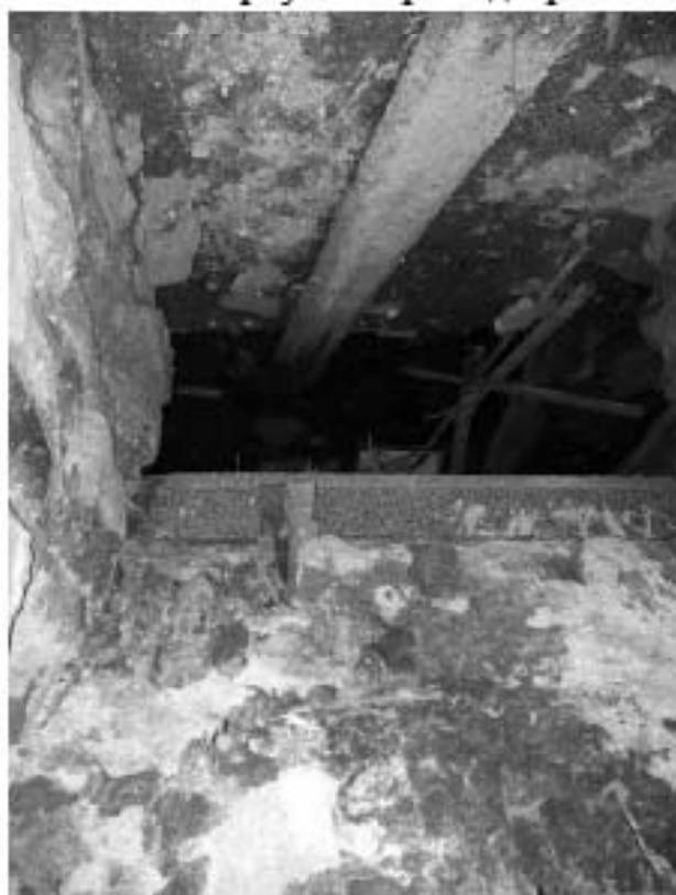
Фото 19. Проем в подвал, недоступен.
