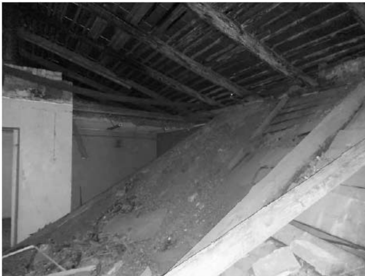
Фото 25. Обрушение перекрытия третьего этажа в пом. 7.
