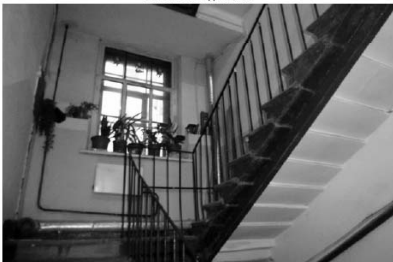
Фото 17. Общий вид 5ЛК.
