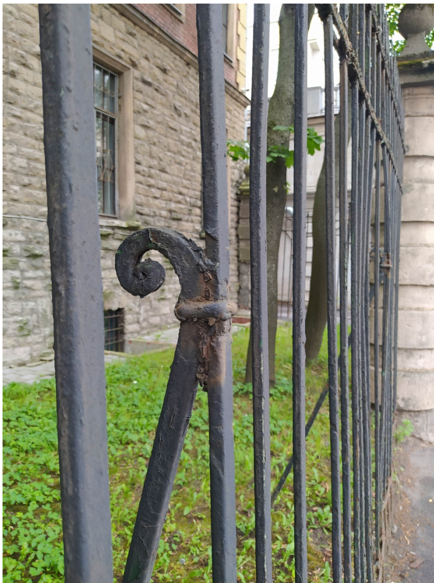
Фрагмент металлической ограды. Крепление контрфорса. Механические повреждения ограды. Дата съёмки 14.07.2022.
