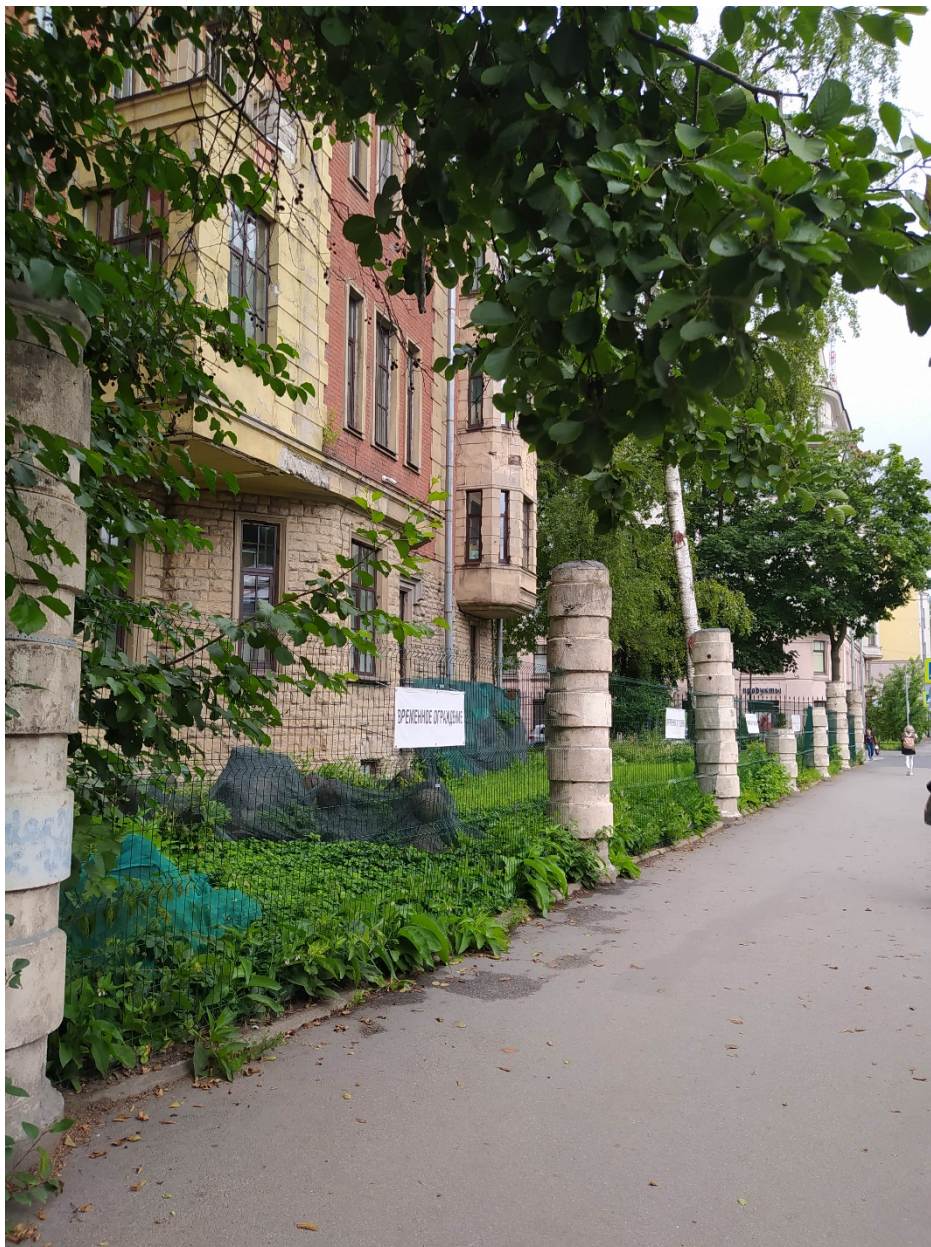
Общий вид со стороны Аптекарского пр. Отсутствуют внутренние металлические секции между муфтированных колонн. Дата съёмки 14.07.2022.
