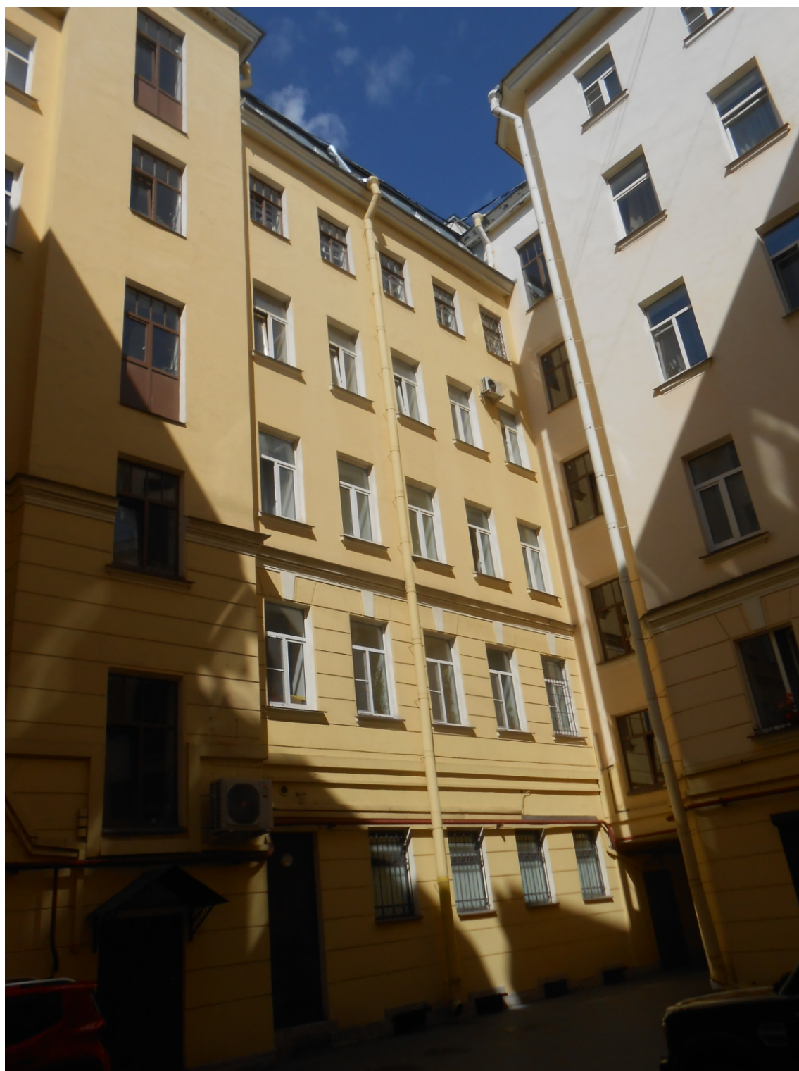
11. “Дом С.Н. Мартенса, А.Н. Тура, С.И. Тимашева”. Восстания ул., 3-5, лит. А. Дворовые фасады. Фото: 20.06.2022.
