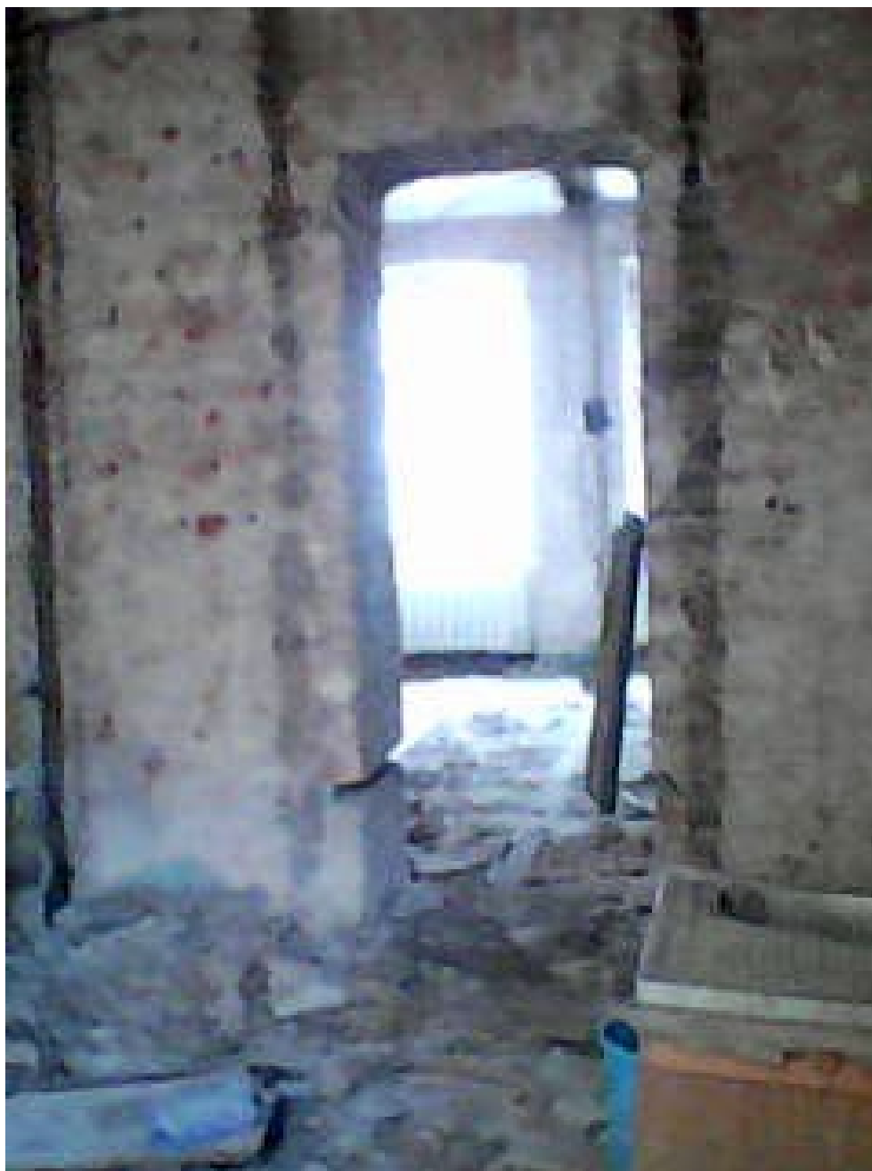
16. “Дом С.Н. Мартенса, А.Н. Тура, С.И. Тимашева”. Восстания ул., 3-5, лит. А. Фрагмент квартиры №7, помещение 12Н. Фото: 20.06.2022.
