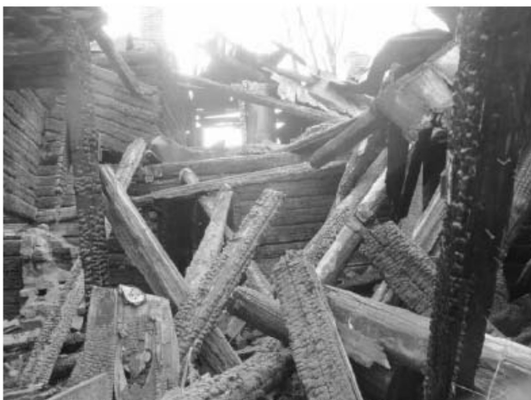
16. ОКН РЗ «Дача Гербель» по адресу: г. Санкт-Петербург, ул. Межозёрная, дом 4, литера А. Вид на помещения здания, повреждённые пожаром. Дата съёмки: 06.04.2016 г.
