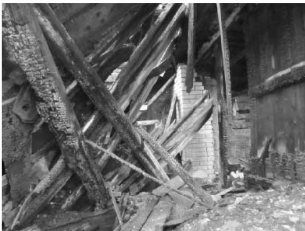
15. ОКН РЗ «Дача Гербель» по адресу: г. Санкт-Петербург, ул. Межозёрная, дом 4, литера А. на помещения здания, повреждённые пожаром. Дата съёмки: 06.04.2016 г.
