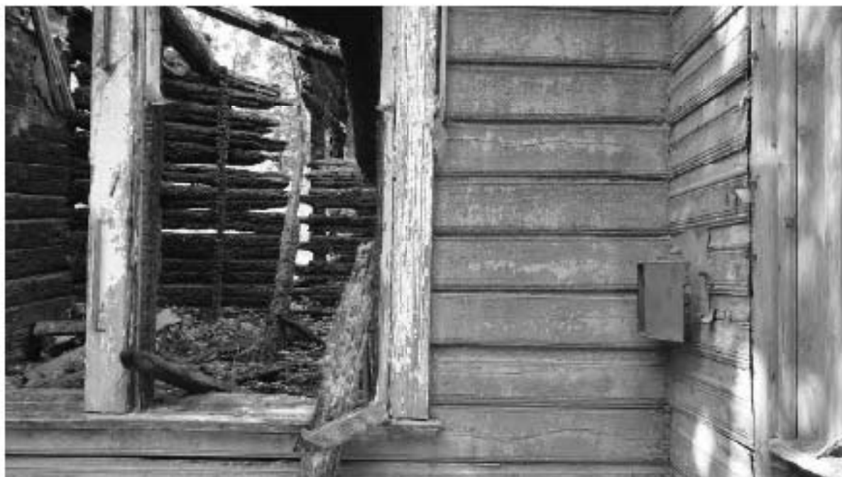
26. ОКН РЗ «Дача Гербель» по адресу: г. Санкт-Петербург, ул. Межозёрная, дом 4, литера А. Восточный фасад. Дата съёмки: 19.06.2019 г.
