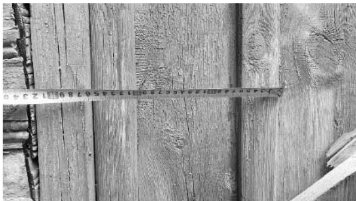
31. ОКН РЗ «Дача Гербель» по адресу: г. Санкт-Петербург, ул. Межозёрная, дом 4, литера А. Фрагмент дощатой обшивки вертикальной со пятачками. Дата съёмки: 19.06.2019 г.
