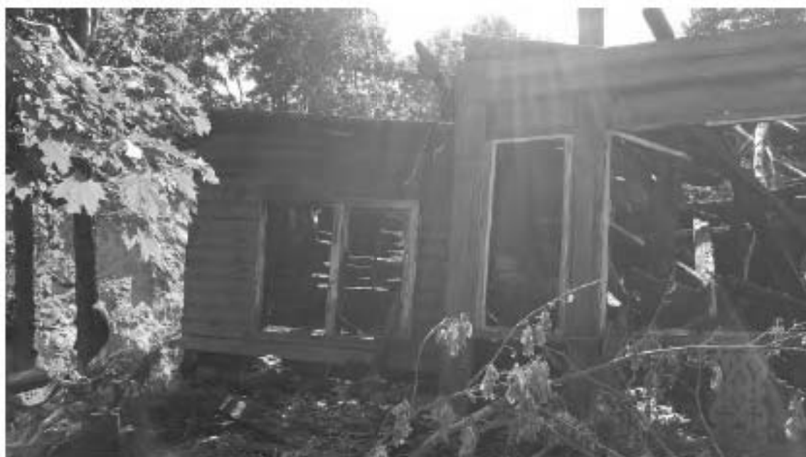
17. ОКН РЗ «Дача Гербель» по адресу: г. Санкт-Петербург, ул. Межозёрная, дом 4, литера А. Восточный фасад. Дата съёмки: 19.06.2019 г.
