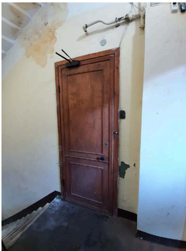
Фото 13 Входная дверь квартиры №48 выявленного объекта культурного наследия «Дом Т.Н. Путиловой» расположенного по адресу: Санкт-Петербург, Большой пр. П.С., д. 44, лит. А
