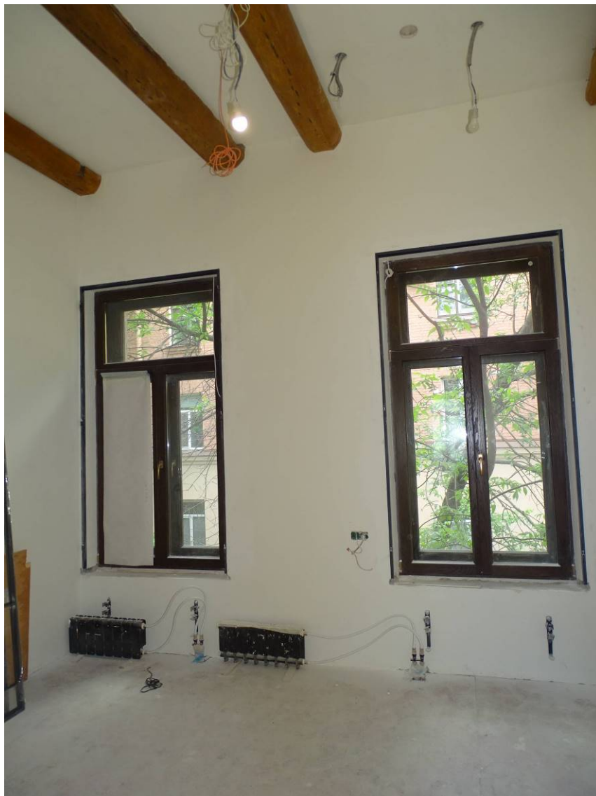
Илл. 22. Здание по адресу: г. Санкт-Петербург, наб. Крюкова кан., д. 23, лит. А. Квартира № 9. 2-й этаж. Пом. 43/16,8. Съемка 08.06.2022 г. Полетайкин В.В.
