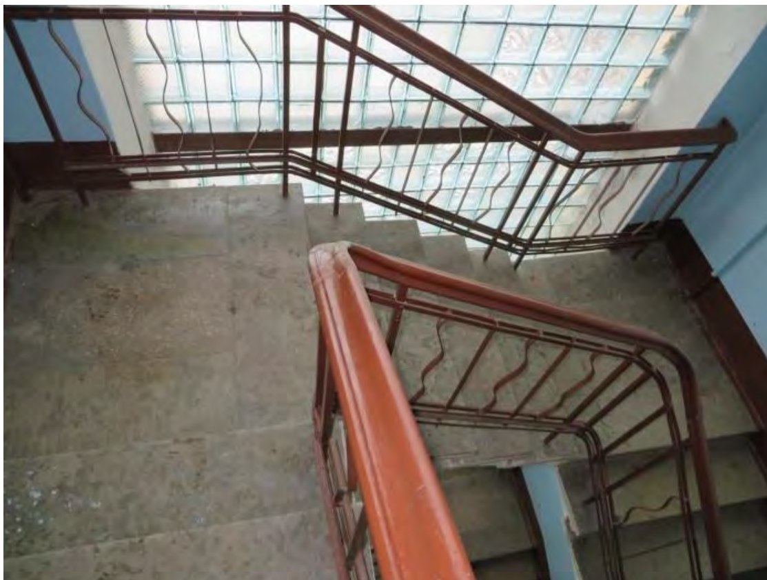
53. Трехмершевая лестница с витражным остеклением дома №61 корп.2 на Лесном пр. Частное фото. ( http://www.citywalls.ru/photo185779.html ).
