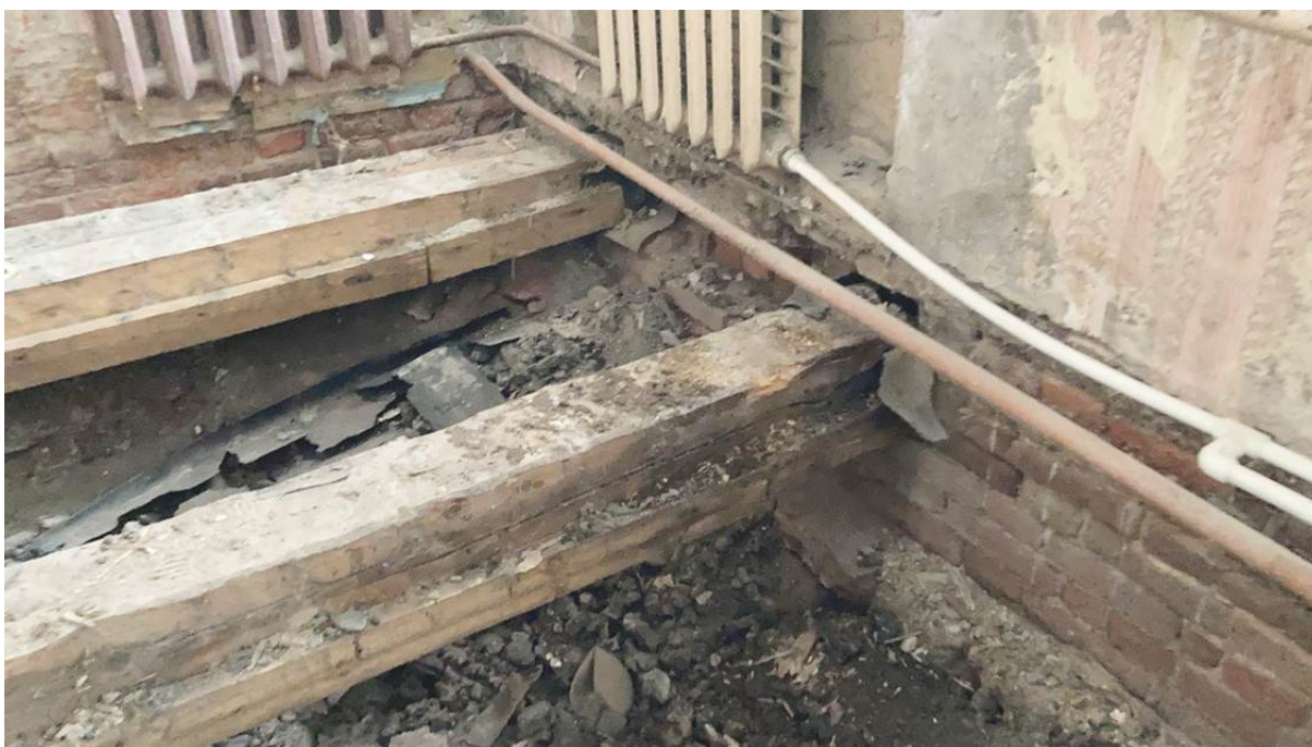
19. Объект культурного наследия регионального значения «3-я линия фруктовых теплиц с квартирами садовников и конторой» в составе объекта культурного наследия регионального значения комплекса «Дворцовые теплицы». Помещение 10. Фрагмент вскрытого пола.
