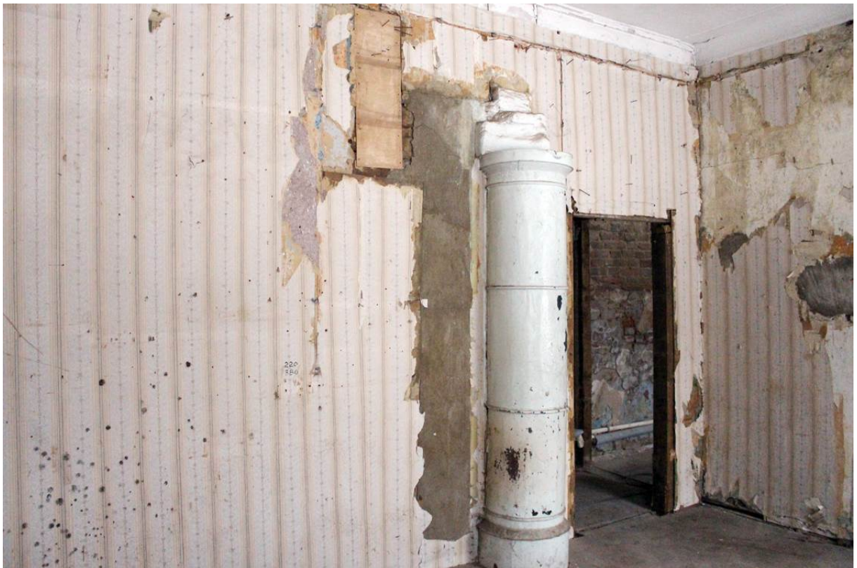
16. Объект культурного наследия регионального значения «3-я линия фруктовых теплиц с квартирами садовников и конторой» в составе объекта культурного наследия регионального значения комплекса «Дворцовые теплицы». Помещение 9. Вид на перегородку между пом. 8 и 9.
