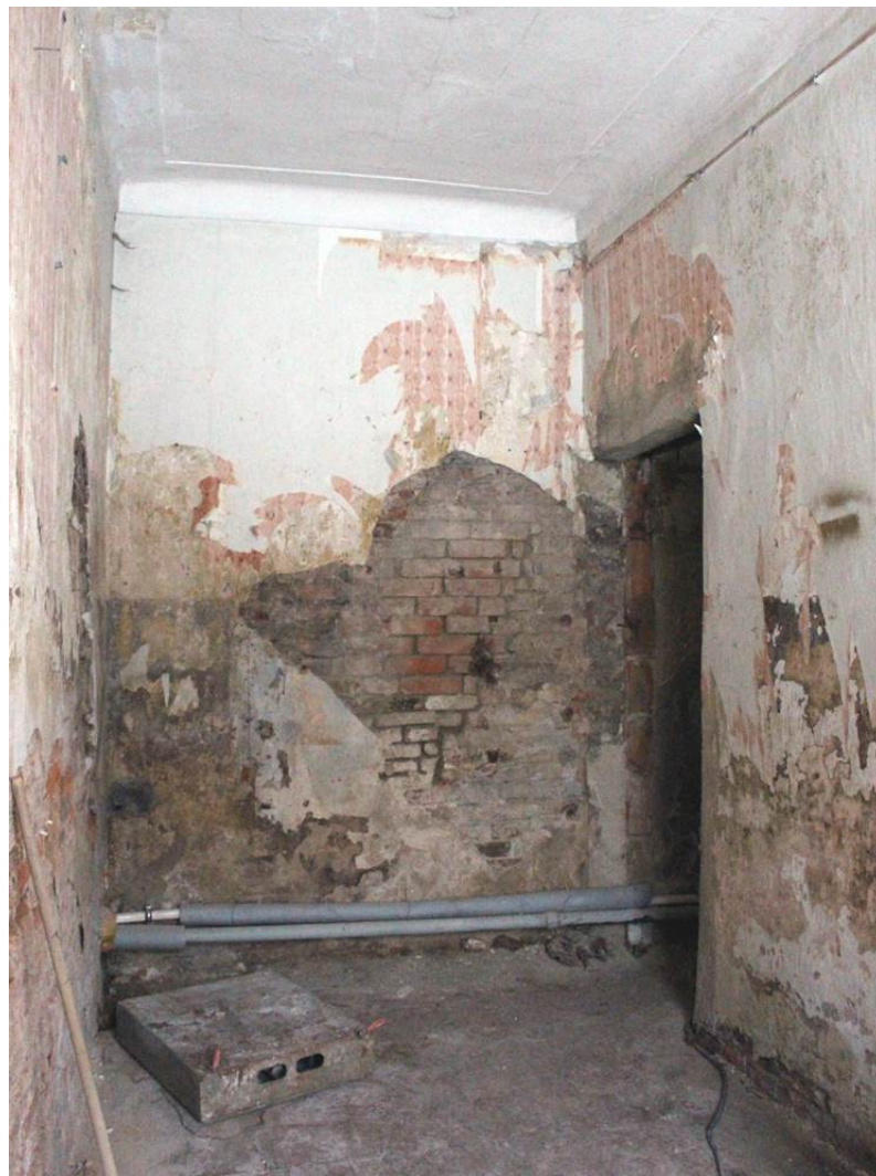
17. Объект культурного наследия регионального значения «3-я линия фруктовых теплиц с квартирами садовников и конторой» в составе объекта культурного наследия регионального значения комплекса «Дворцовые теплицы». Помещение 10. Вид от стены по оси А в сторону внутренней стены по оси Б.
