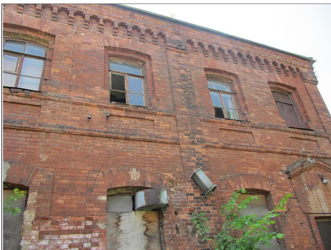
Фото 7. Объект культурного наследия регионального значения «Товарная контора Варшавского вокзала». Фрагмент северного фасада.
