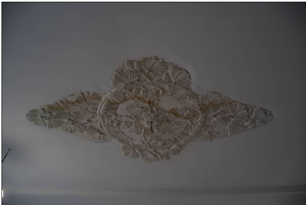
41. Квартира №15. Вид в помещении 15. Фрагмент. Фото 08.06.2022 г.
