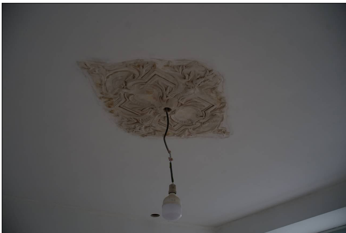
38. Квартира №15. Вид в помещении 2. Фрагмент. Фото 08.06.2022 г.
