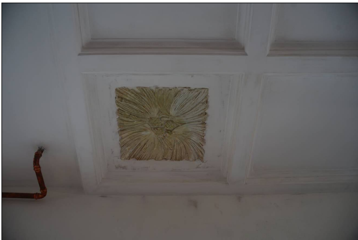
42. Квартира №15. Вид в помещении 15. Фрагмент. Фото 08.06.2022 г.
