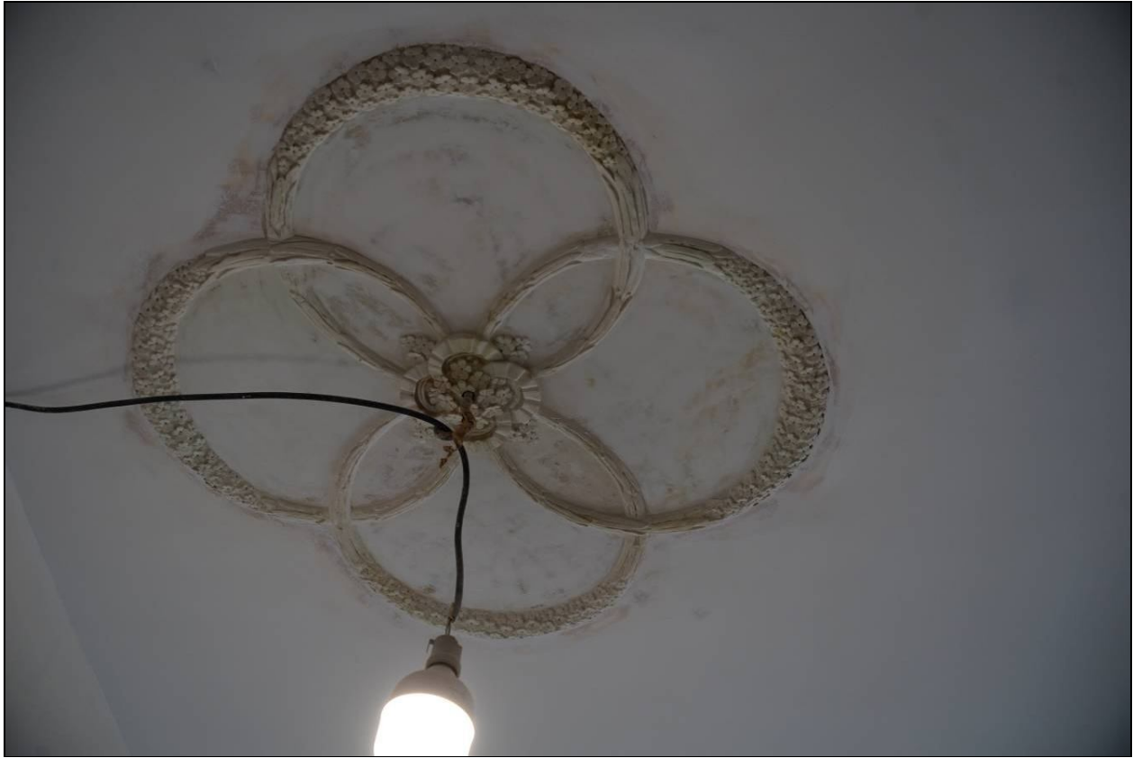
44. Квартира №15. Вид в помещении 3. Фрагмент. Фото 08.06.2022 г.
