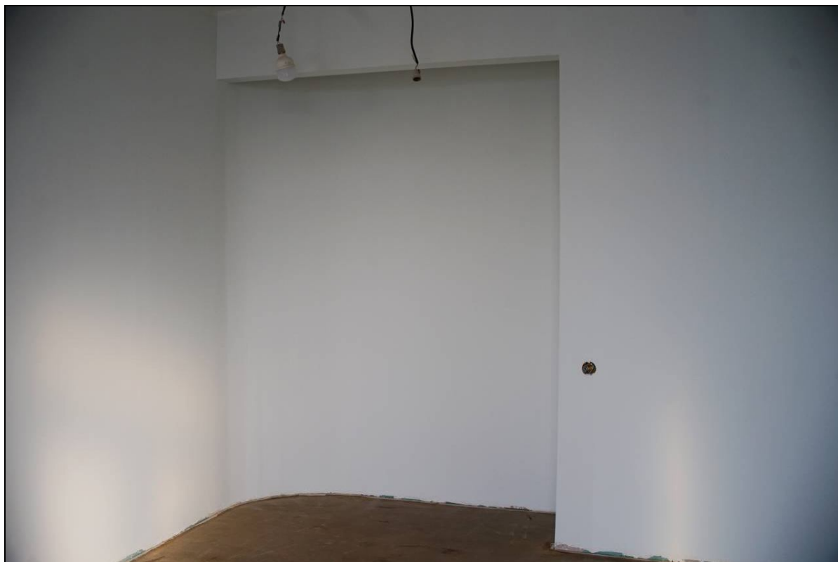
37. Квартира №15. Вид в помещении 1. Фрагмент. Фото 08.06.2022 г.
