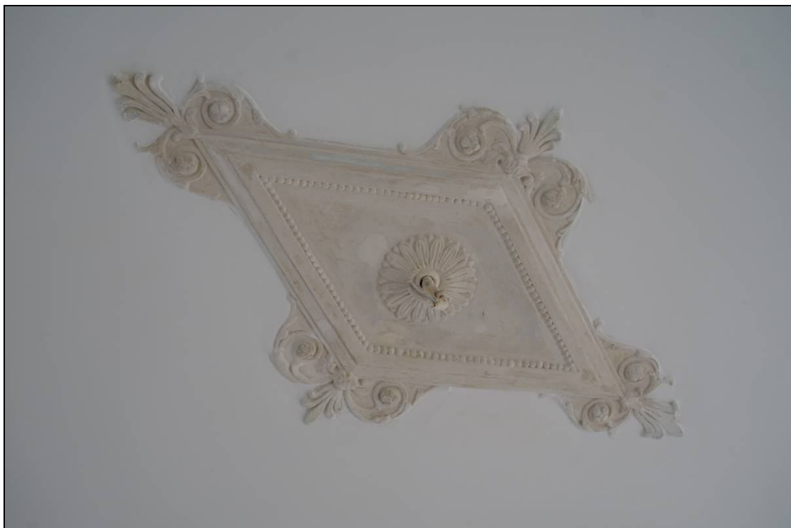
48. Квартира №15. Вид в помещении 7. Фрагмент. Фото 08.06.2022 г.
