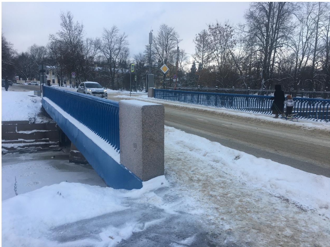
7. Вид на объект культурного наследия регионального значения «Синий мост через Обводный канал» по адресу г. Кронштадт, Макаровская улица. Направление съемки северо-восток.
