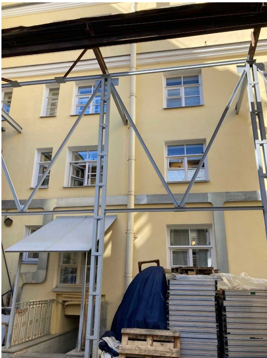
Фото 17. ОКН федерального значения «Театр Михайловский» (Санкт-Петербург, Искусств пл., 1, Инженерная ул., 1, кан. Грибоедова наб. 4). Двор. Водосточные трубы
