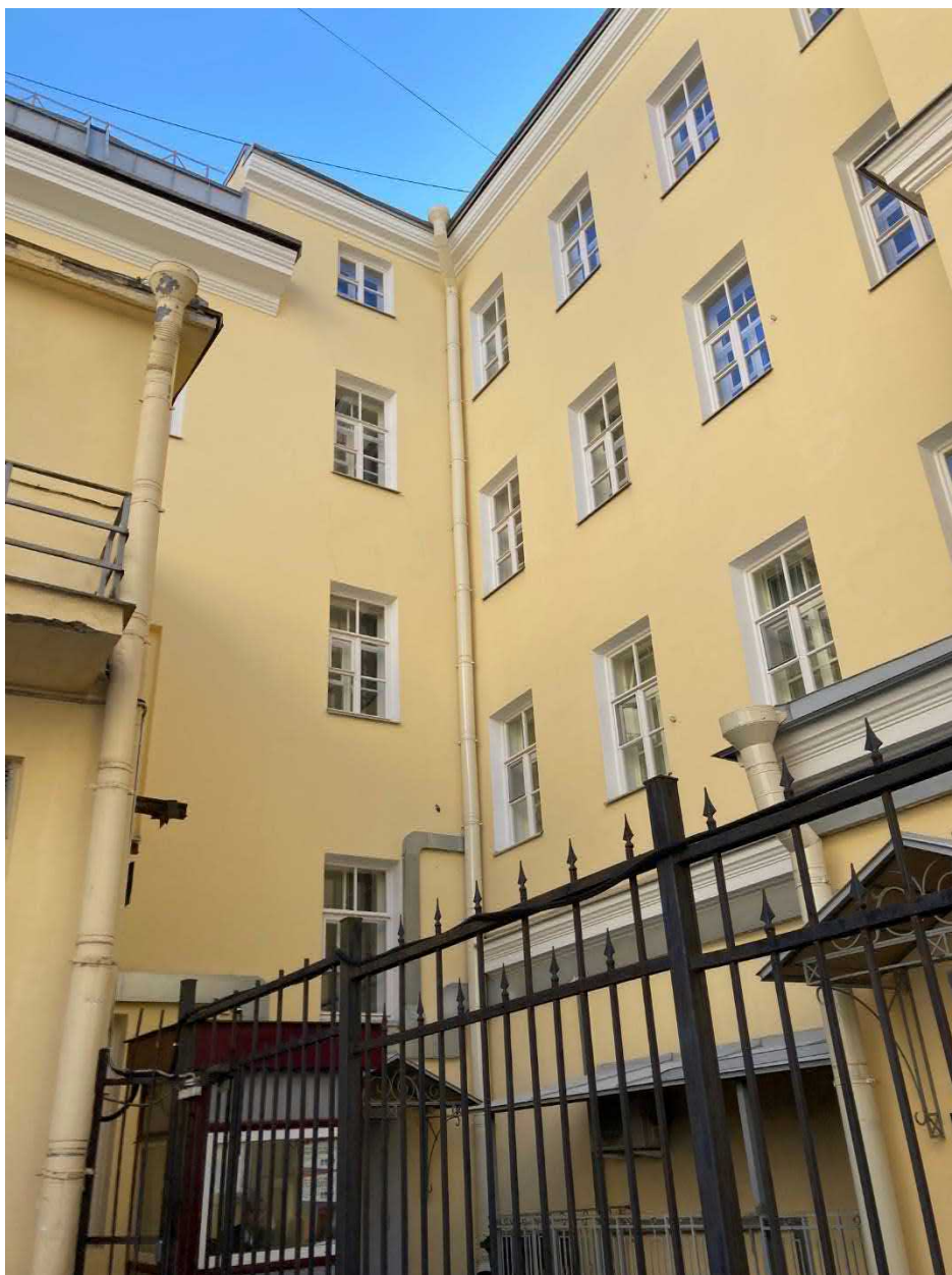
Фото 14. ОКН федерального значения «Театр Михайловский» (Санкт-Петербург, Искусств пл., 1, Инженерная ул., 1, кан. Грибоедова наб. 4). Двор. Водосточные трубы
