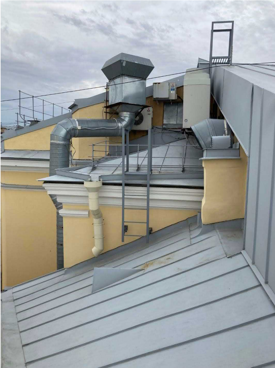
Фото 9. ОКН федерального значения «Театр Михайловский» (Санкт-Петербург, Искусств пл., 1, Инженерная ул., 1, кан. Грибоедова наб. 4). Крыша
