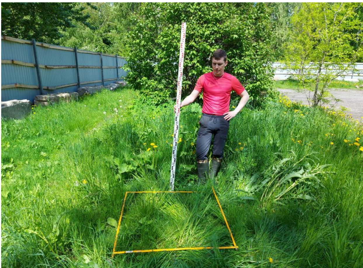
Рис. 15. Шурф № 1. Общий вид на место заложения шурфа до начала работ. Вид на север.
