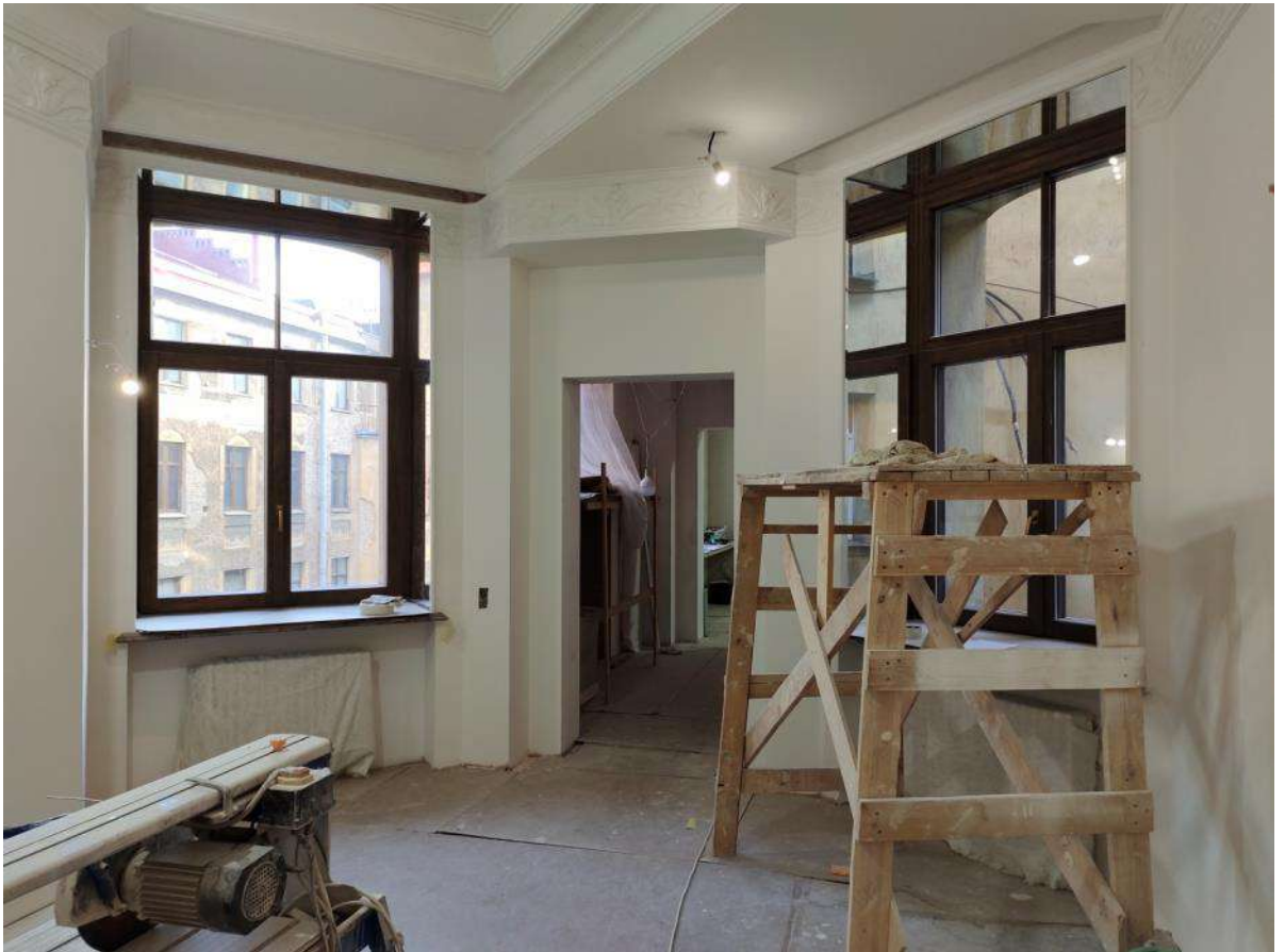
32. Объект культурного наследия регионального значения «Дом М.П. Толстого» (г. Санкт-Петербург, Фонтанки р. наб., 54; Рубинштейна ул., 15-17). Помещение квартиры № 563.
