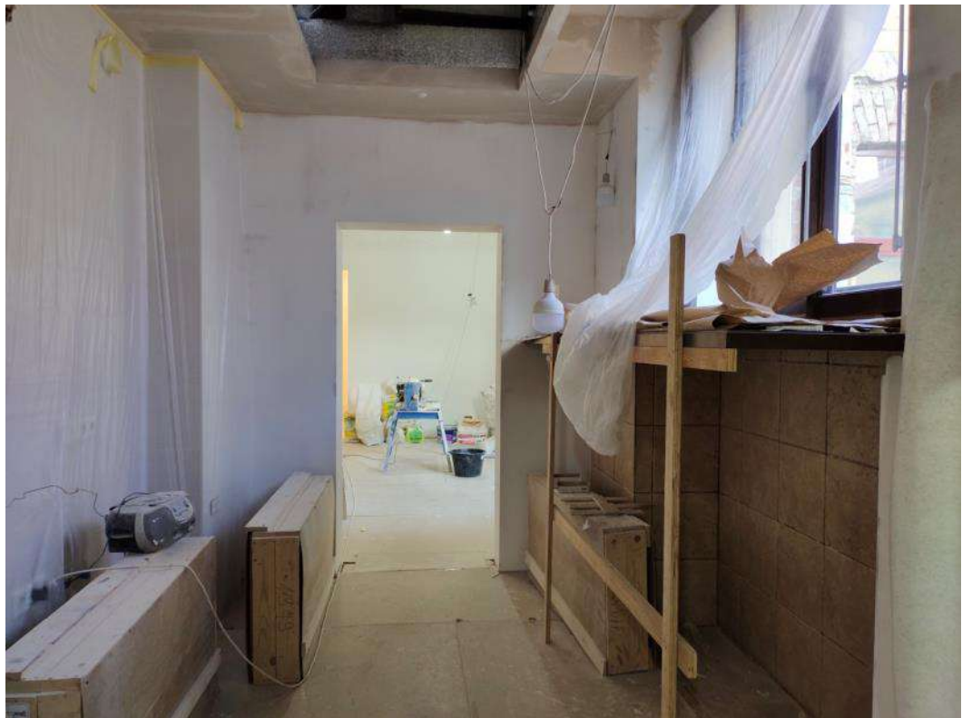
27. Объект культурного наследия регионального значения «Дом М.П. Толстого» (г. Санкт-Петербург, Фонтанки р. наб., 54; Рубинштейна ул., 15-17). Помещение квартиры № 563.
