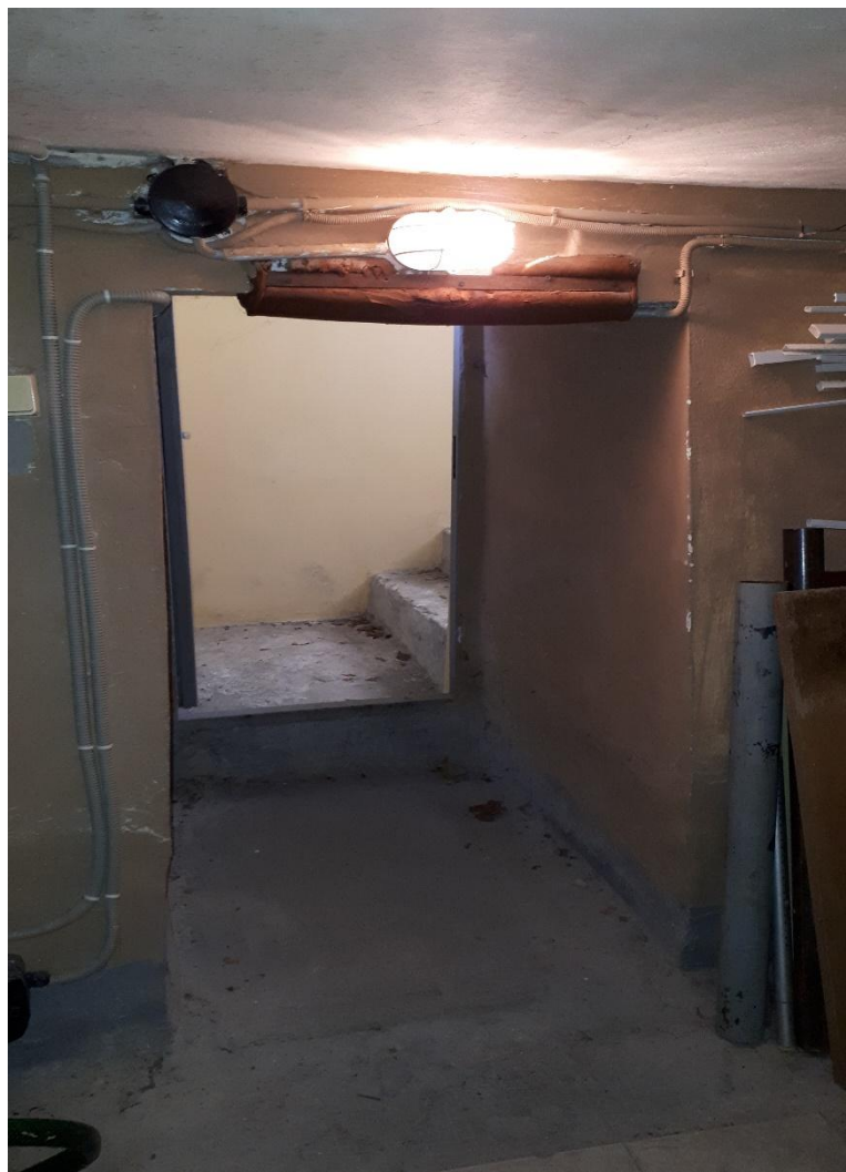
7. Выявленный объект культурного наследия «Дом Белозеровых» по адресу: г. Санкт-Петербург, Пушкинский район, г. Пушкин, ул. Конюшенная, д.33/35, лит. А. Помещение подвала. Теплоцентр. Фрагмент интерьера.
