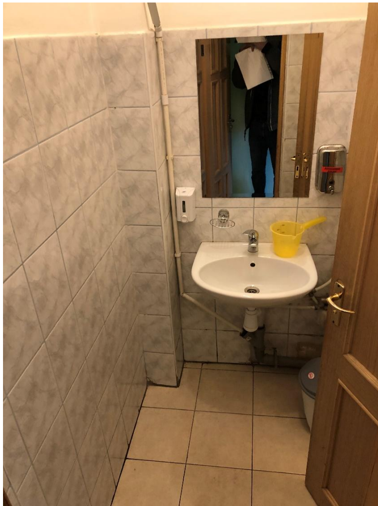
17. Выявленный объект культурного наследия «Дом Белозеровых» по адресу: г. Санкт-Петербург, Пушкинский район, г. Пушкин, ул. Конюшенная, д.33/35, лит. А. Первый этаж. Санузел. Умывальная. Общий вид.
