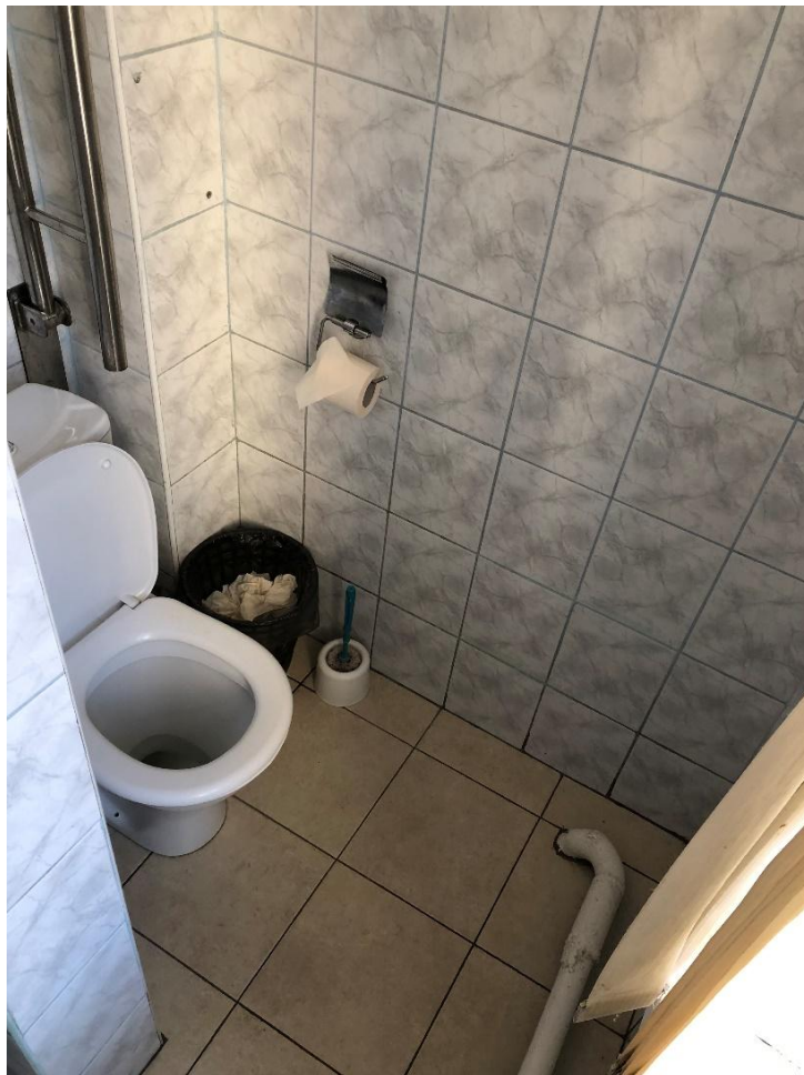
16. Выявленный объект культурного наследия «Дом Белозеровых» по адресу: г. Санкт-Петербург, Пушкинский район, г. Пушкин, ул. Конюшенная, д.33/35, лит. А. Первый этаж. Санузел. Туалет. Общий вид.
