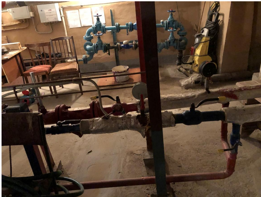
8. Выявленный объект культурного наследия «Дом Белозеровых» по адресу: г. Санкт-Петербург, Пушкинский район, г. Пушкин, ул. Конюшенная, д.33/35, лит. А. Помещение подвала. Теплоцентр. Фрагмент интерьера.
