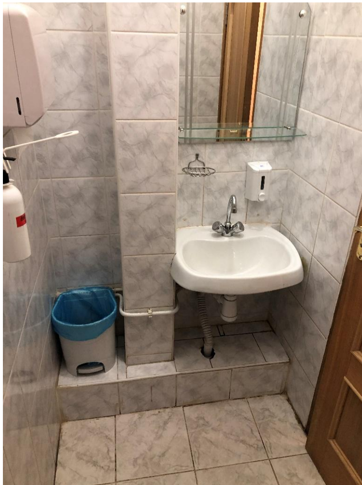
32. Выявленный объект культурного наследия «Дом Белозеровых» по адресу: г. Санкт-Петербург, Пушкинский район, г. Пушкин, ул. Конюшенная, д.33/35, лит. А. Третий этаж. Санузел. Фрагмент интерьера.
