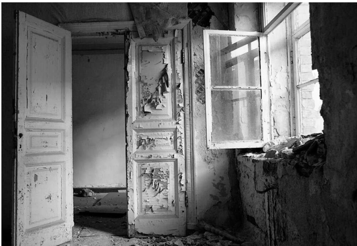
Илл. 124. Интерьер квартиры, 2016 г. Фото из группы Вконтакте «Дом Лермонтова на Садовой, 61» https://vk.com/dom_lermontova
