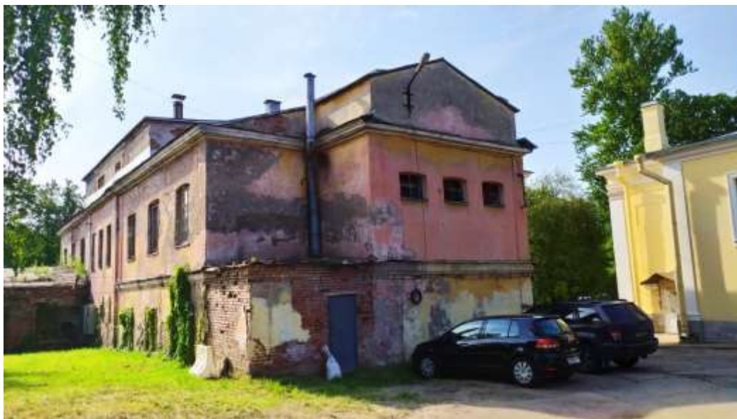
фото 3. Вид со стороны Госпитальной улицы. В средней части здания заложены два оконных проема кирпичной кладкой. Имеются разрушения штукатурного слоя и кирпичной кладки, выветривание раствора. Отсутствует отмостка здания.
