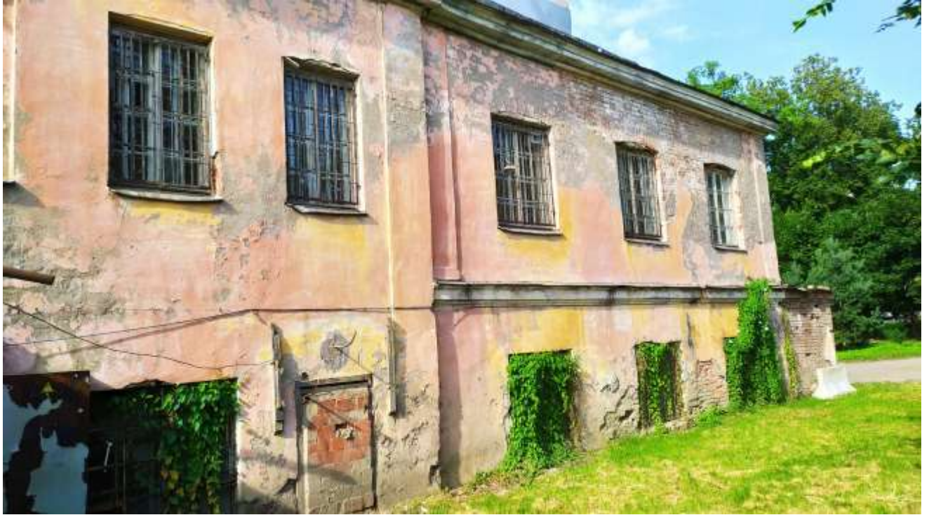
фото 5. Вид со стороны Октябрьского бульвара. В средней части здания заложен дверной проема кирпичной кладкой. Имеются разрушения штукатурного слоя и кирпичной кладки, выветривание раствора. Отсутствует отмостка здания.
