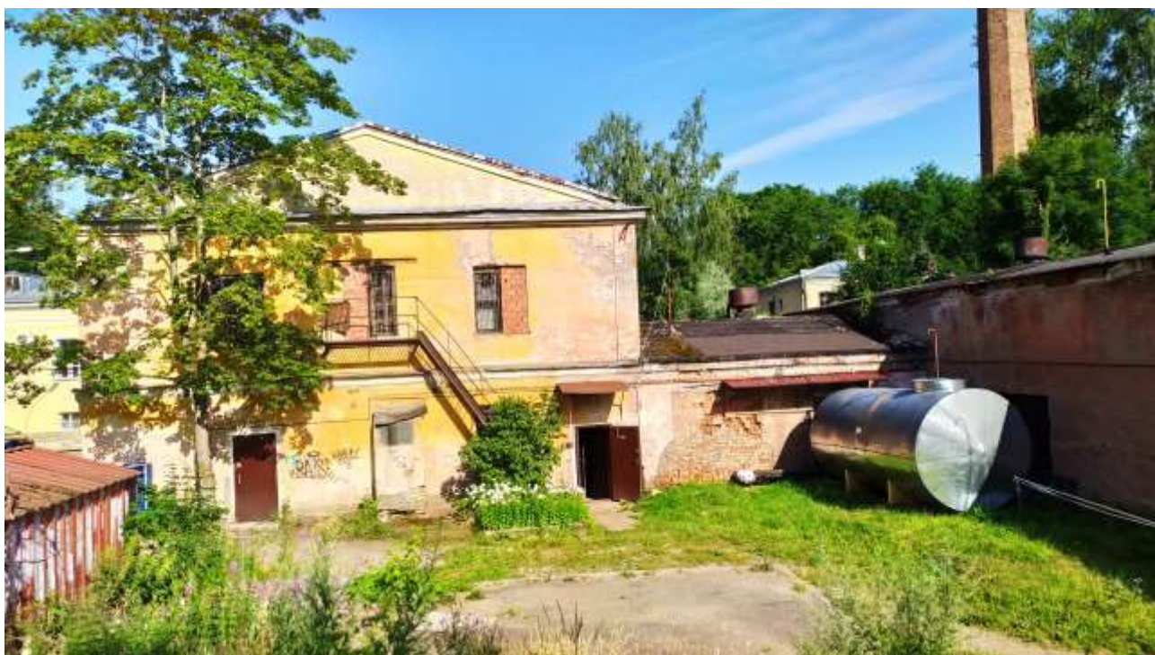
фото 12. Вид со стороны Софийского бульвара (помещение котельной). Имеются разрушения штукатурного слоя и кирпичной кладки, выветривание раствора. Отсутствует отмостка здания.
