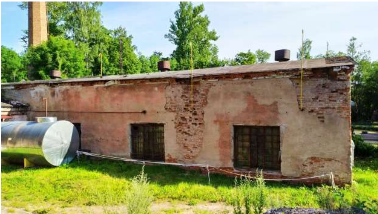
фото 11. Вид со стороны Московского переулка (помещение котельной). Имеются разрушения штукатурного слоя и кирпичной кладки, выветривание раствора. Отсутствует отмостка здания.
