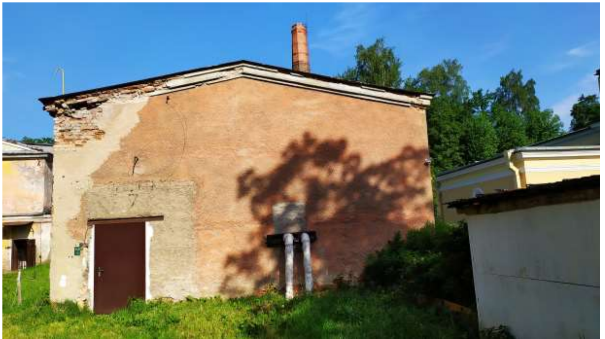
фото 10. Вид со стороны Софийского бульвара (помещение котельной). Имеются разрушения штукатурного слоя и кирпичной кладки, выветривание раствора. Отсутствует отмостка здания.
