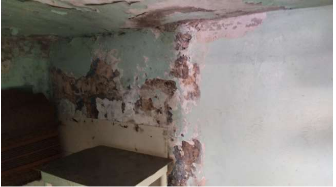
фото 14. Место протечки потолка. Блок 1.
