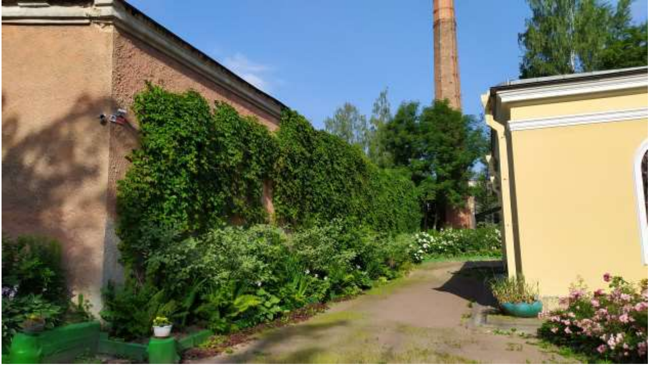
фото 9. Вид со стороны Октябрьского бульвара (помещение котельной). Имеются разрушения штукатурного слоя и кирпичной кладки, выветривание раствора. Отсутствует отмостка здания. Сильная поросль на месте отмостки.
