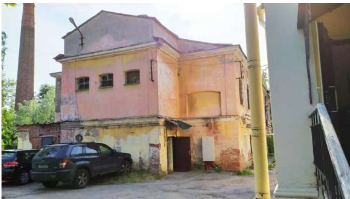
фото 4. Вид со стороны Госпитальной улицы. В средней части здания, на первом этаже заложены три оконных проема кирпичной кладкой. Имеются разрушения штукатурного слоя и кирпичной кладки, выветривание раствора. Отсутствует отмостка здания.
