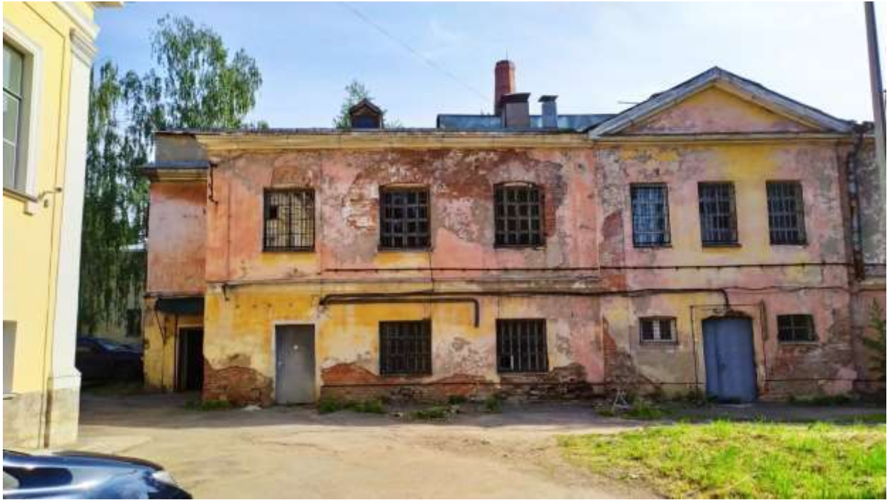
фото 1. Главный фасад здания, вид со стороны Московского переуллка. Разрушение штукатурного слоя, выветривание раствора кирпичной кладки, разрушения отмостки.
