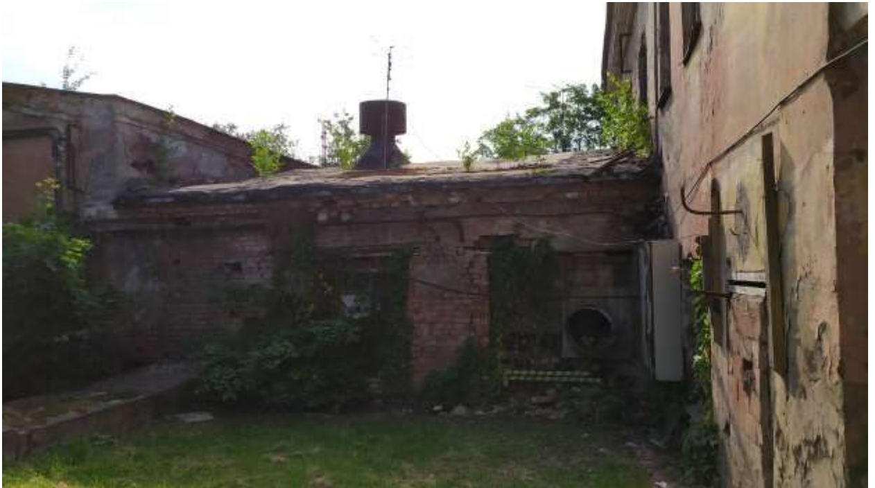
фото 6. Вид со стороны Госпитальной улицы (помещение насосной). Имеются разрушения штукатурного слоя и кирпичной кладки, выветривание раствора. Отсутствует отмостка здания.
