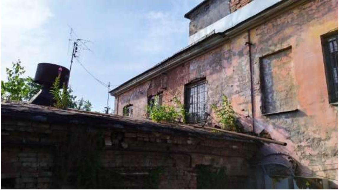
фото 7. Вид со стороны Октябрьского бульвара (помещение насосной). Имеются разрушения штукатурного слоя и кирпичной кладки, выветривание раствора.
