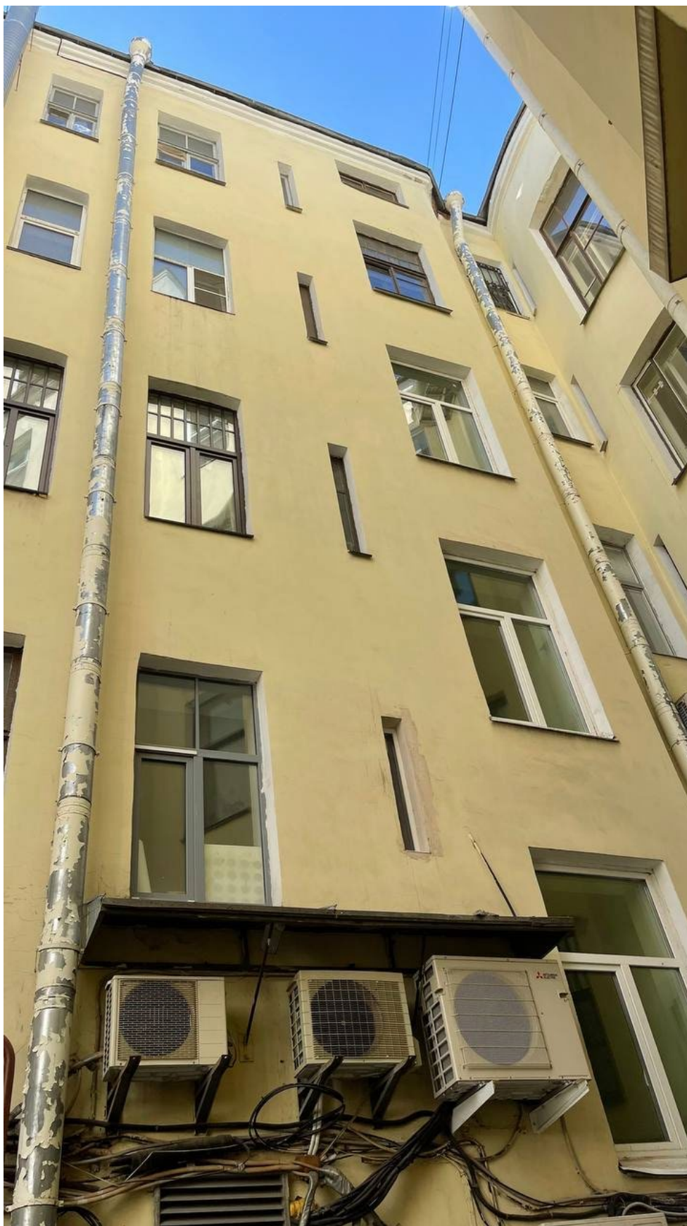
5. Дворовой фасад здания по адресу: г. Санкт-Петербург, Каменноостровский пр., д. 13/2, лит. А;
