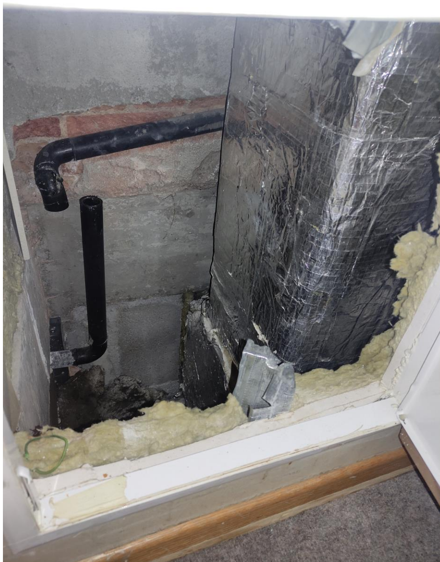
Фото 23. Объект культурного наследия регионального значения «Дом, в котором с 1869 г. жил и в 1887 г. умер актер Самойлов Василий Васильевич», расположенный по адресу: г. Санкт-Петербург, Невский проспект, дом 57, литера А. Технологическая шахта, существующие сети.
