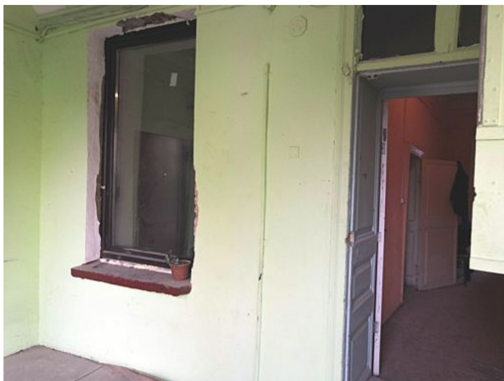
Фото 10. Вход в квартиру №16 и оконный проем кухни, выходящий в холл лестницы.
